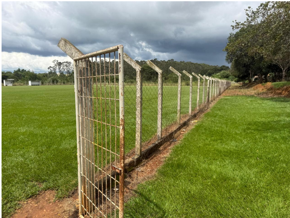
Imagem 07 - Portão de acesso ao campo com sinais de degradação, bem como a estrutura do alambrado.
