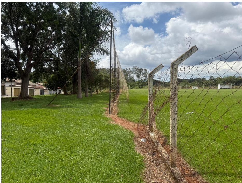
Imagem 08 - Estruturas dos alambrados com sinais de deterioração e instabilidade.
