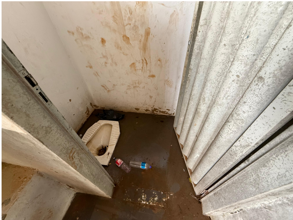
Imagem 05 - Banheiros com instalações inadequadas e sem acessibilidade. Paredes, piso e porta em mau estado de conservação.
