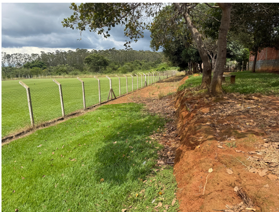
Imagem 06 - Inadequação da contenção do solo.
