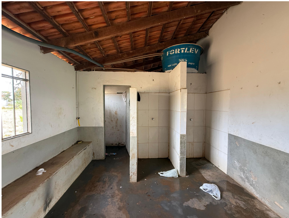
Imagem 03 - Na parte interna aos banheiros e vestiários vê-se a necessidade de adequação hidrossanitária, como a instalação de duchas.
