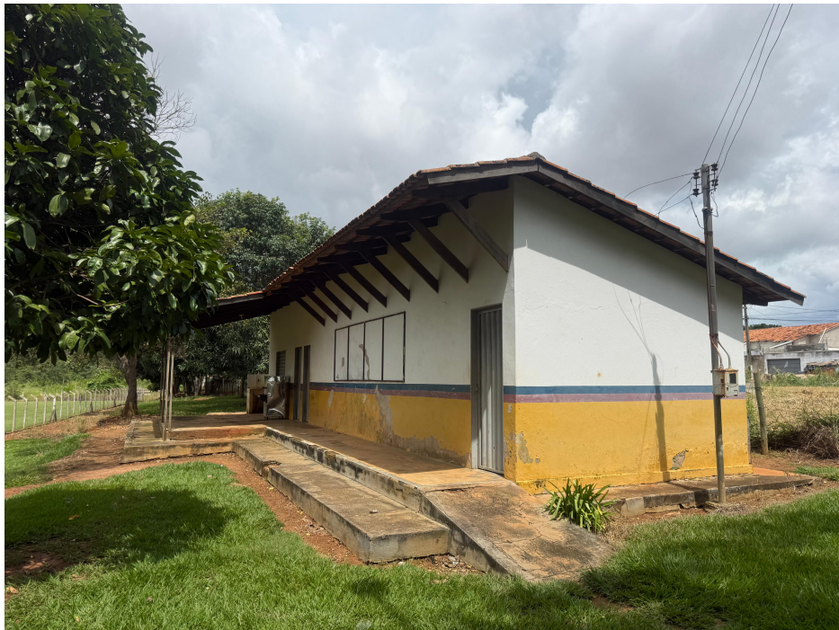
Imagem 01 - Espaço coberto do campo, que abriga os vestiários e demais espaços de convivência. Na imagem é possível analisar a falhas na acessibilidade e inadequações elétricas.
