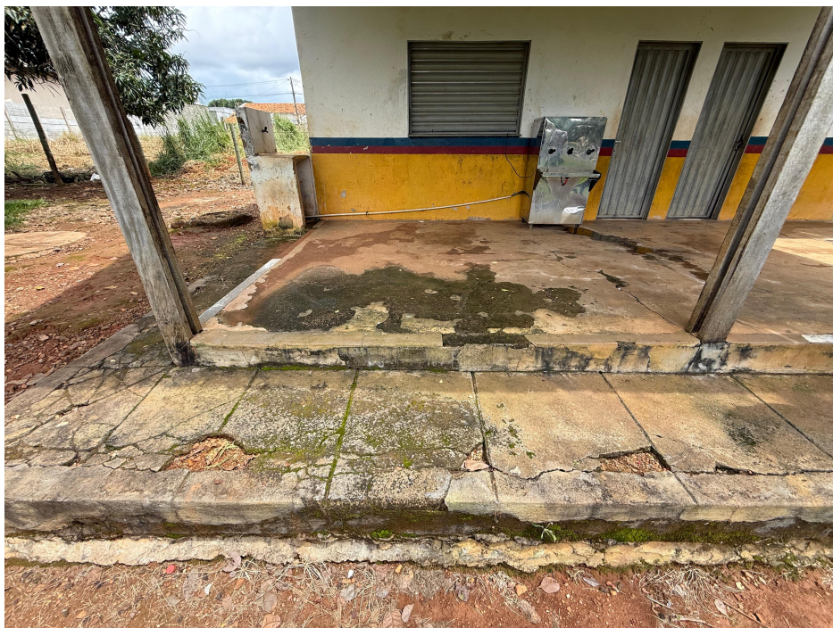
Imagem 02 - Pavimentação com trincas, rachaduras e lascamentos, além de baixa resistência a infiltração da umidade. Na imagem também é possível detectar a necessidade de adequações no sistema hidrossanitário.
