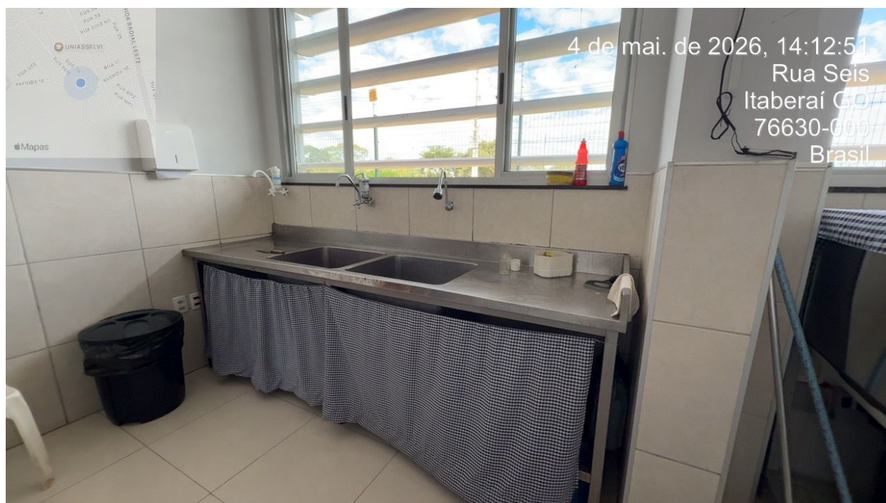
Imagem 1 - Situação atual da cozinha.
