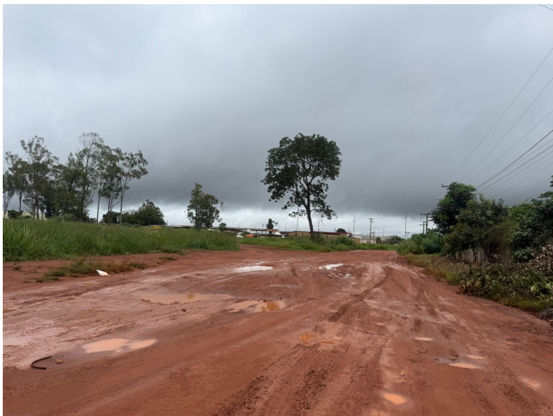
Imagem 03 - Via com vários pontos com água empochada e deformidades.
