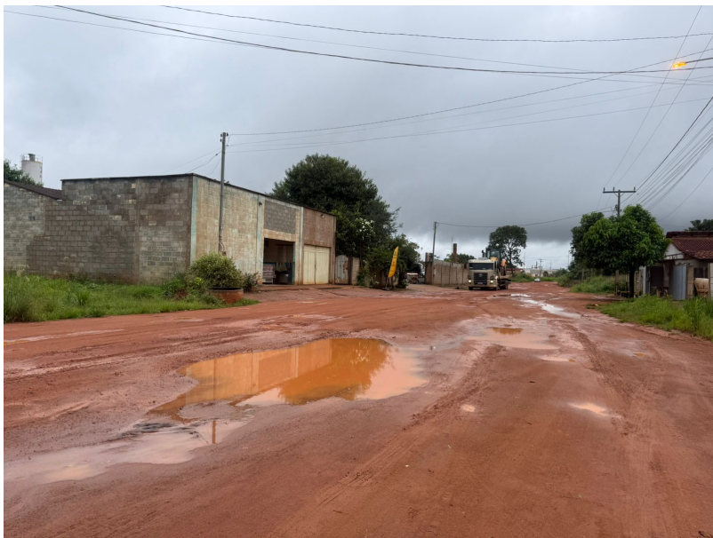
Imagem 02 - Via irregular, não pavimentada e com acúmulo de águas pluviais.
