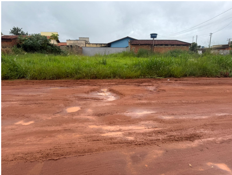
Imagem 04 - Via não pavimentada e com deformidades.
