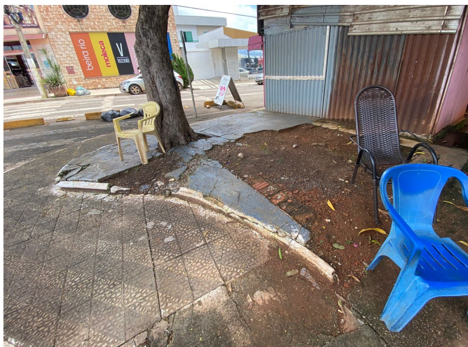
Imagem 02 - Calçadas com irregularidades, falhas e desníveis.
