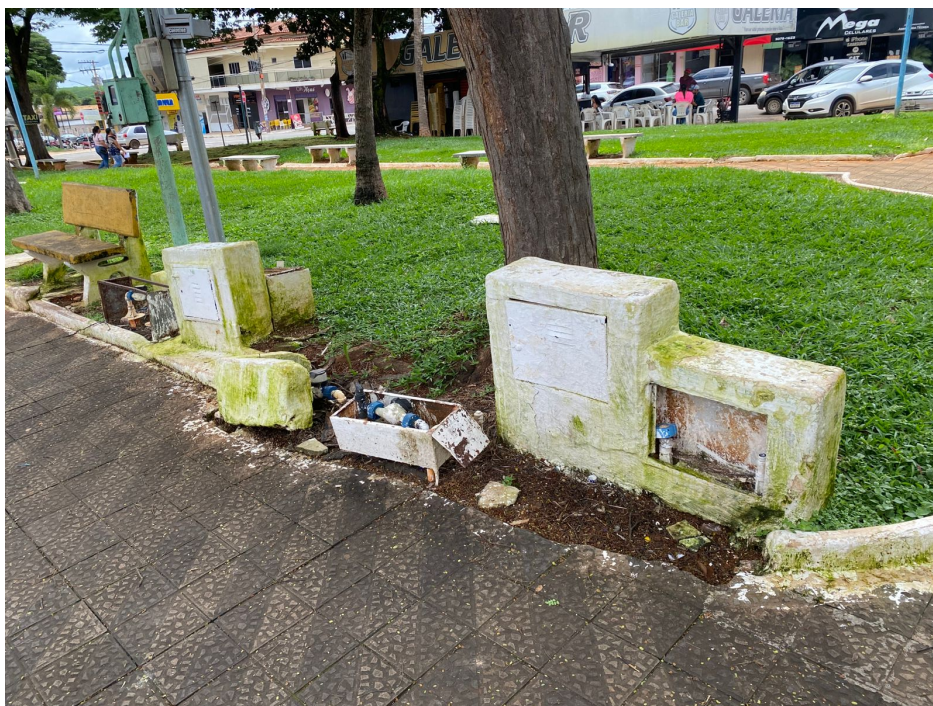
Imagem 04 - Irregularidades nos pontos de energia e de água potável.
