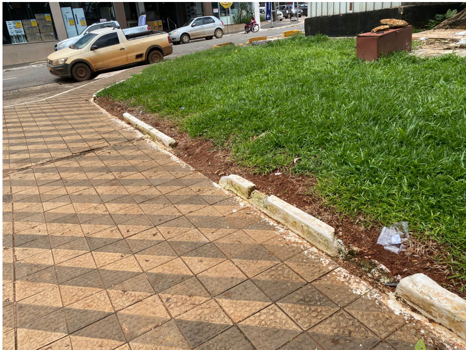
Imagem 03 - Meio-fios com danos.
