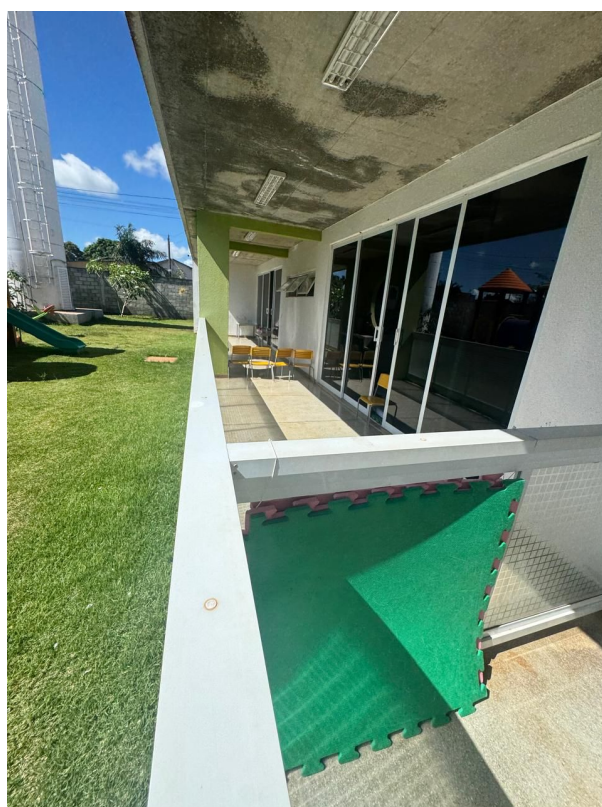
Imagem 5 - Laje com infiltração aparente.
