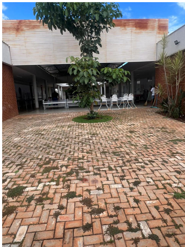
Imagem 3 - Estrutura metálica danificada com ferrugem.
