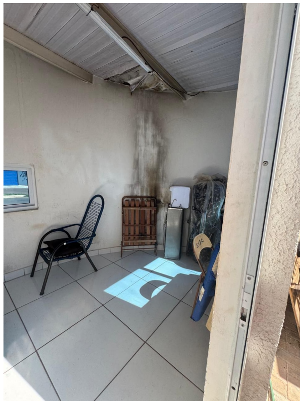
Imagem 4 - Acesso de águas pluviais ao interior da edificação por falha no sistema de cobertura e consequente danificação dos revestimentos da alvenaria.
