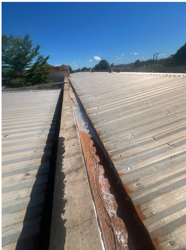
Imagem 6 - Cobertura com calhas danificadas e fios aparentes.
