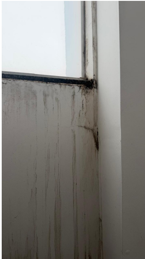
Imagem 1 - Sinais de infiltração por deficiência de vedação na janela.
