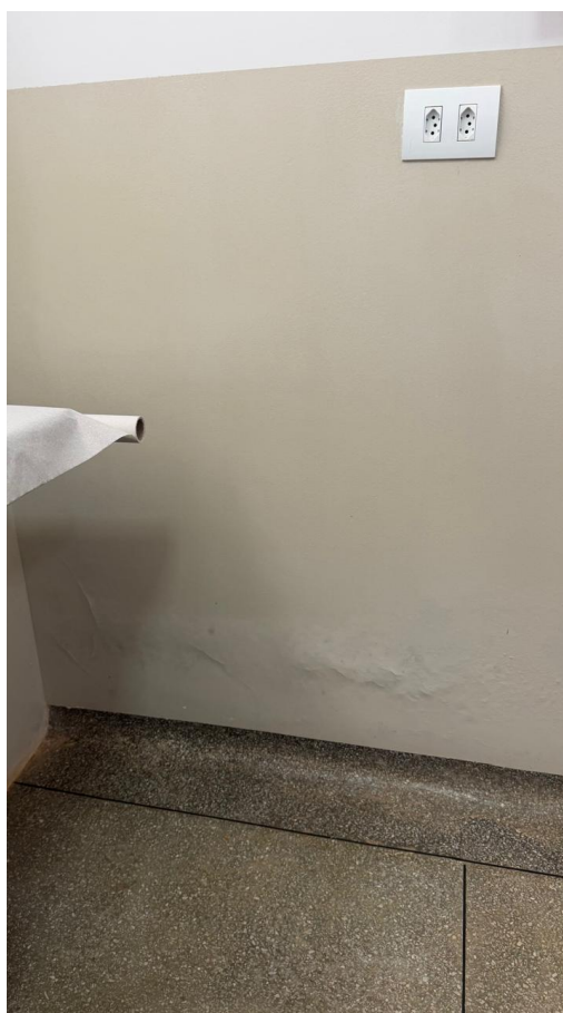
Imagem 3 - Sinais de danos na pintura do barrado por possível infiltração.
