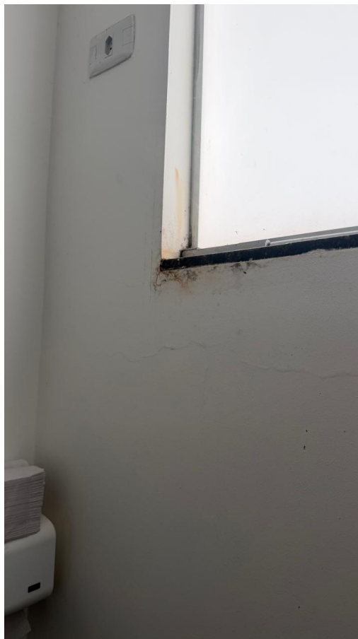
Imagem 2 - Sinais de infiltração na janela e com manchas nas paredes.
