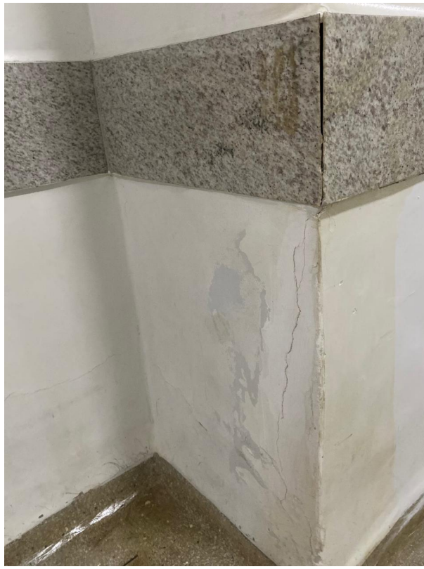
Imagem 8 - Manifestação patológica caracterizada por deslocamento do revestimento, deslocamento da pintura e umidade aparente, comprometendo a integridade dos acabamentos e as condições de salubridade do ambiente.
