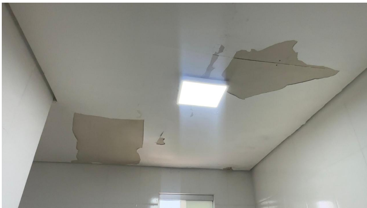
Imagem 3 - Patologia no revestimento do forro de gesso acartonado.
