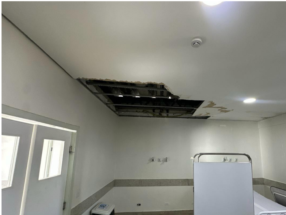
Imagem 2 - Forro danificado por infiltração de águas pluviais.
