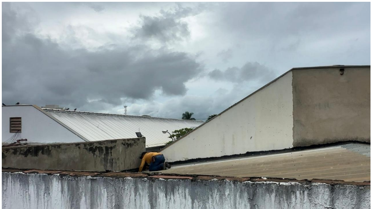
Imagem 10 - Umidade nas paredes da platibanda por falta de elemento de proteção como a pingadeira.
