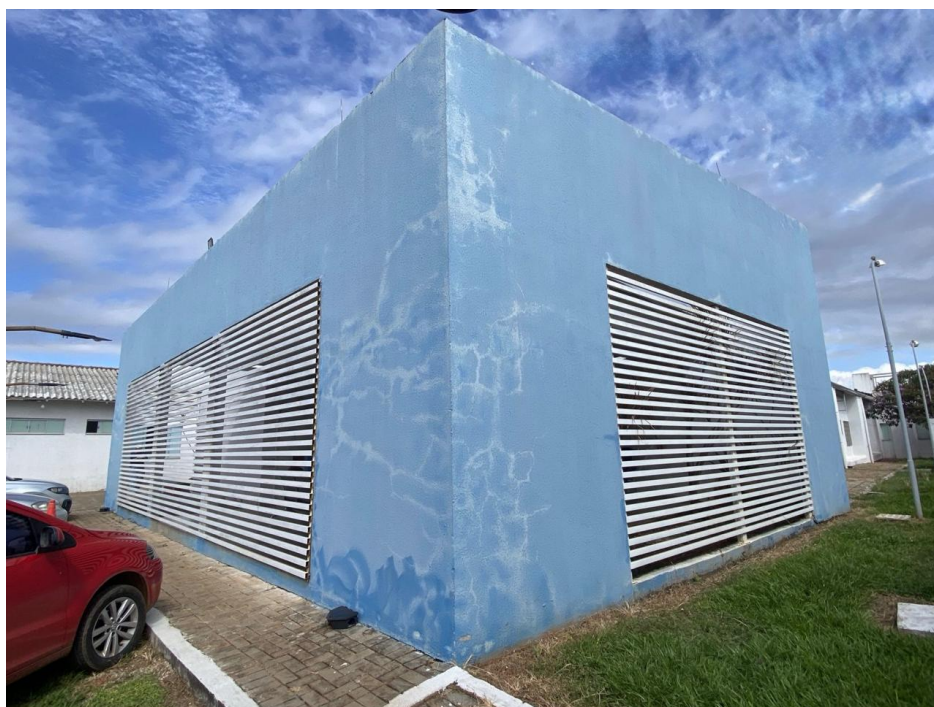
Imagem 7 - Presença de eflorescência em revestimento externo, indicando ocorrência de umidade e migração de sais solúveis através dos elementos construtivos.
