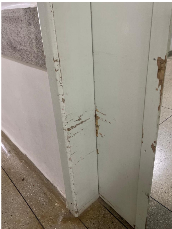
Imagem 17 - Portas com defeitos de uso.
