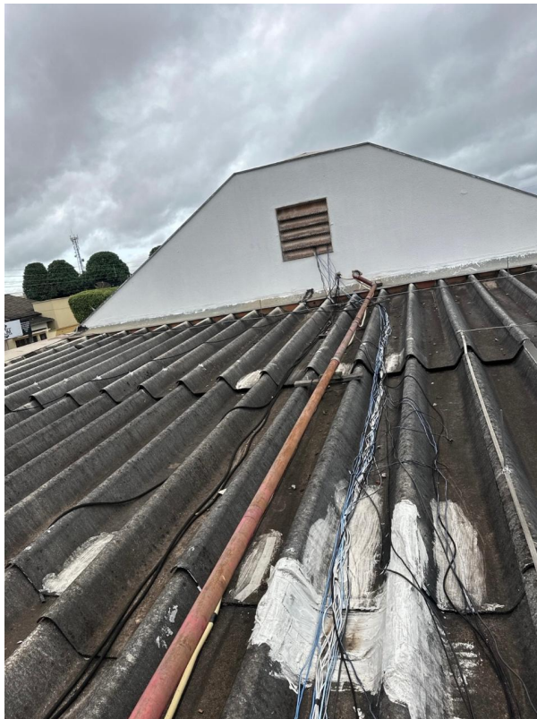
Imagem 12 - Fiação aparente apoiada sobre o telhado.
