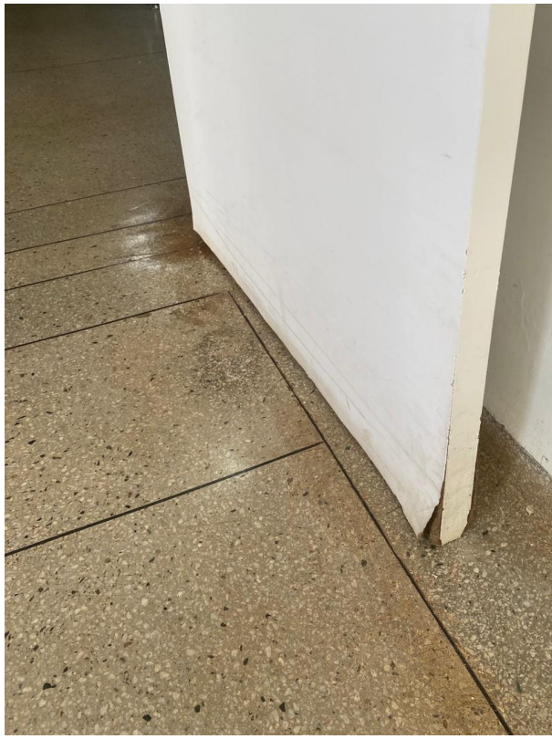
Imagem 16 - Portas com inchaço por umidade.
