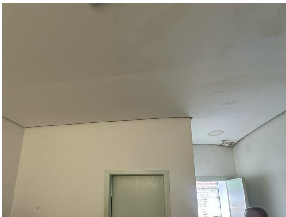
Imagem 5 - Danos no forro por manifestação patológica com biodeterioração causada por umidade.
