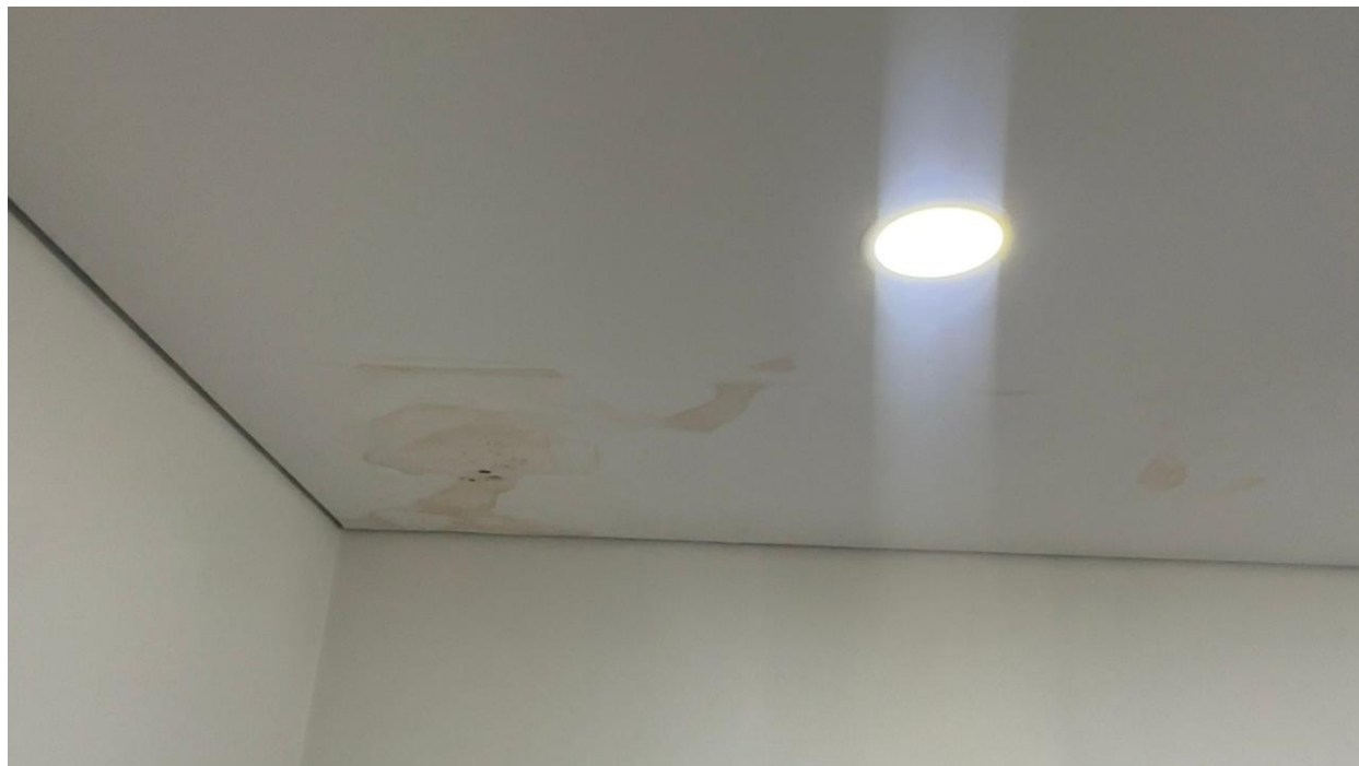
Imagem 4 - Manchas provenientes do acesso de águas pluviais no forro.
