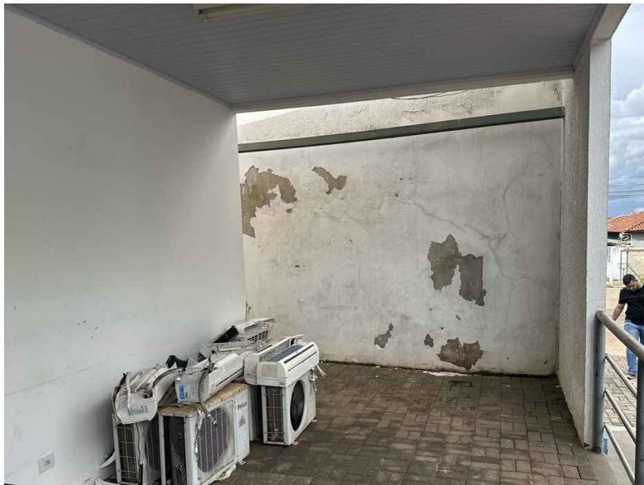
Imagem 9 - Deslocamento da pintura e umidade aparente.
