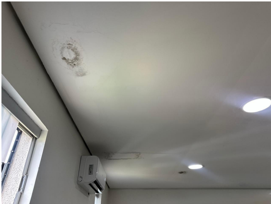
Imagem 1 - Forro com manifestação patológica decorrente da umidade.
