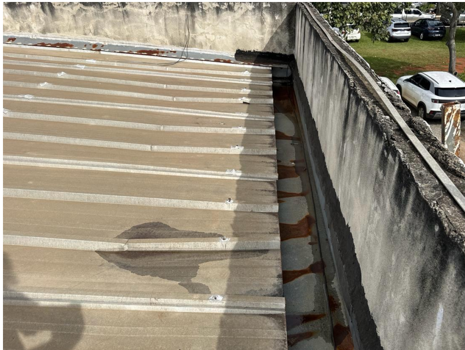
Imagem 11 - Calhas com aparente ferrugem e furos, telha com tortuosidade e acúmulo de água, além da infiltração proveniente da falta de elemento de proteção.
