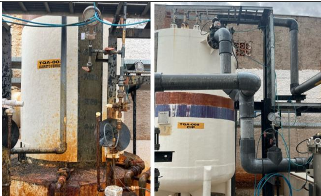
Imagem 03 –Válvulas e peças de PCV U em uma das bombas dosadoras (soda caustica)
