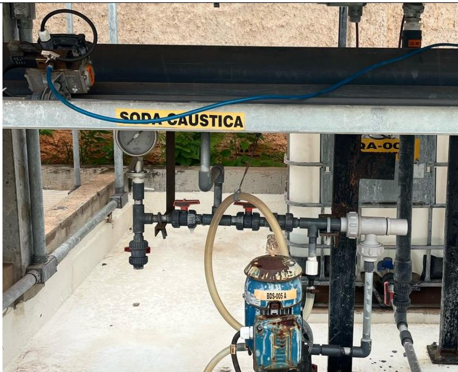
Imagem 04 –Válvulas e peças de PCV U nas linhas e tanque de lodo.
