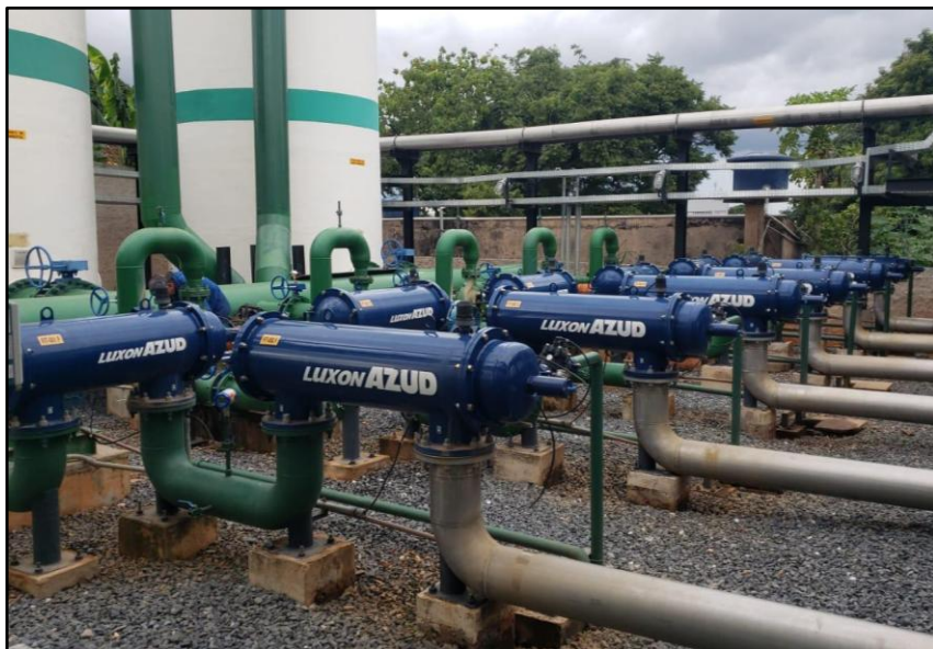
Figura 3. Filtros telas de 1000 micras e 6 filtros telas de 300 microns na ETA
