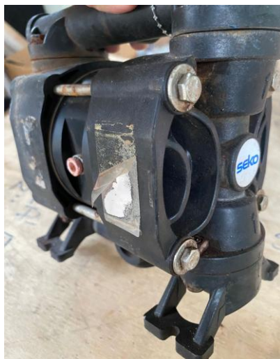
Figura 7 - Bomba SEKO de Material PVDF utilizada no CEB alcalino.
