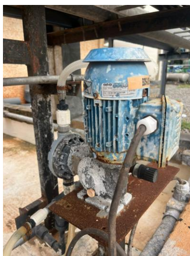
Figura 9 - Bomba à motor para a dosagem de Soda Cáustica
