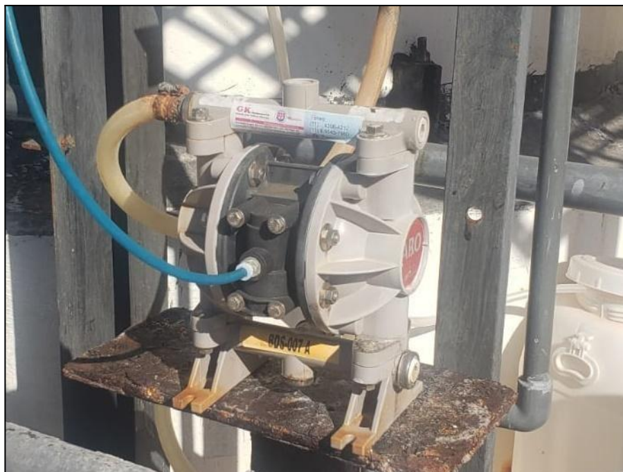
Figura 2 – Bomba pneumática de polipropileno para dosagem de hipoclorito de sódio 12%
