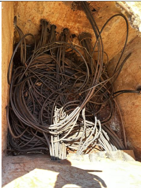
Acondicionamento inadequado dos cabos.
