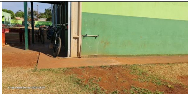
Ponto de abastecimento em desconformidade
