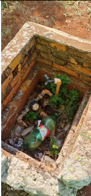
Abrigo do hidrômetro em condições inadequadas
