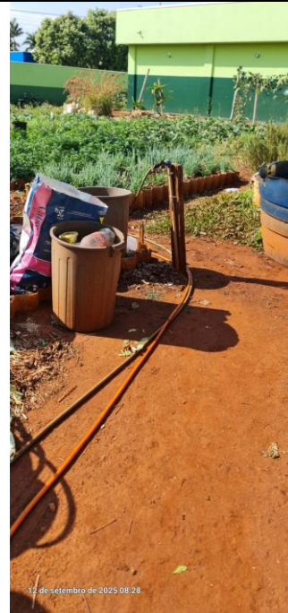
Ponto de abastecimento em desconformidade
