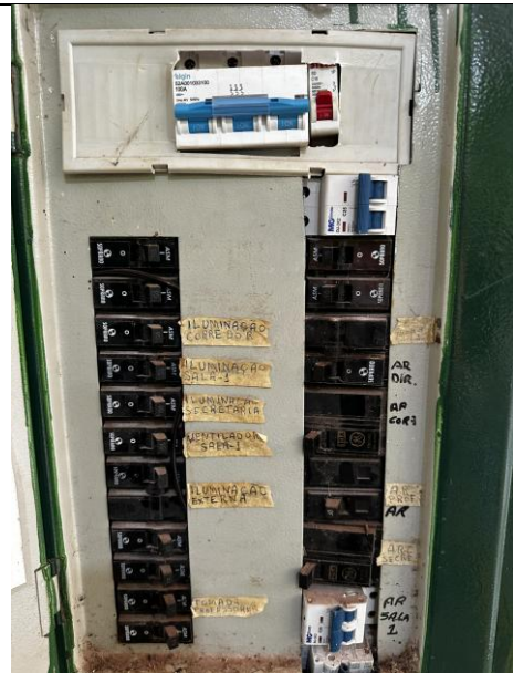
Quadro com adequações irregulares
