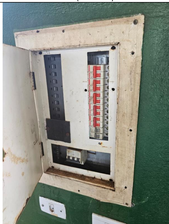
QUADRO ELÉTRICO (COBERTA)
