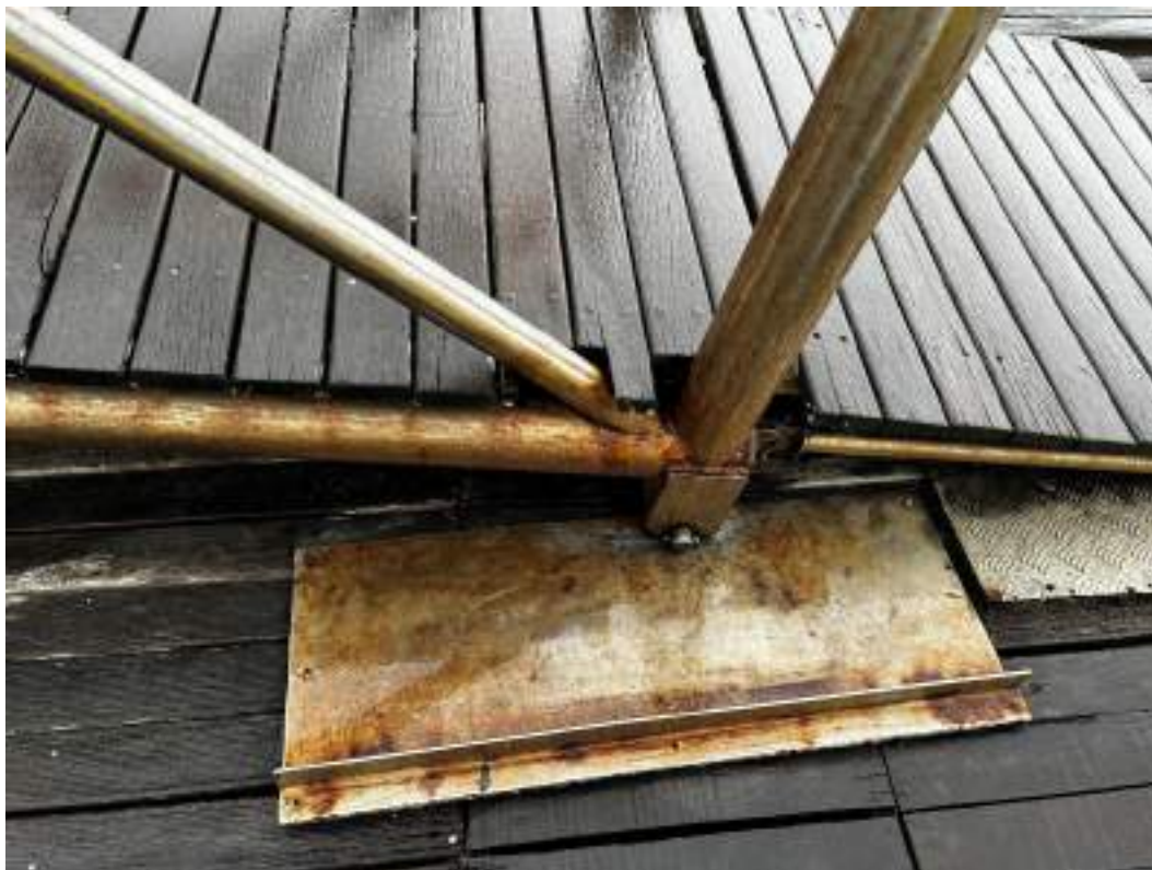
Foto 19 – Ausência dos roletes de deslizamento da passarela articulada provocando danos no piso do flutuante.
