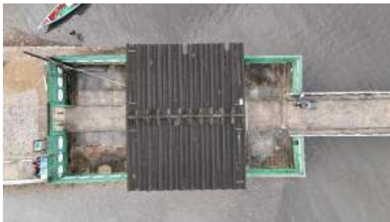
Foto 21 – Telhado danificado do Terminal Receptivo.
