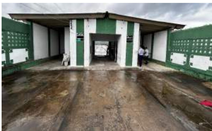
Foto 22 – Recalque no piso do Terminal Receptivo.
