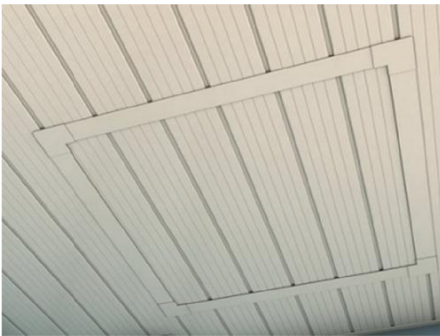
ABERTURA NO FORRO
