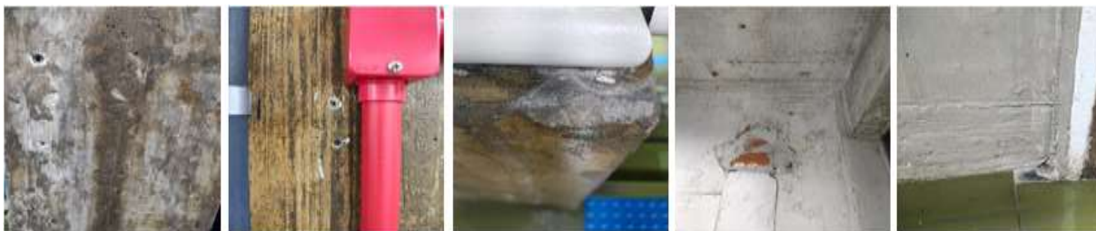
Exemplos de danos em colunas e muretas que deverão ser restaurados
