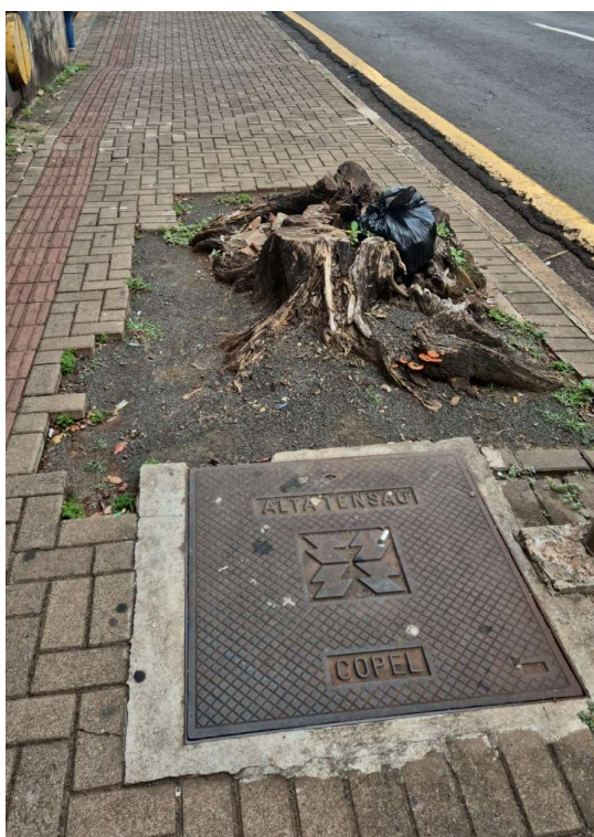
Foto 1 - Retirar toco de árvore com recomposição do passeio e correção dos desníveis
