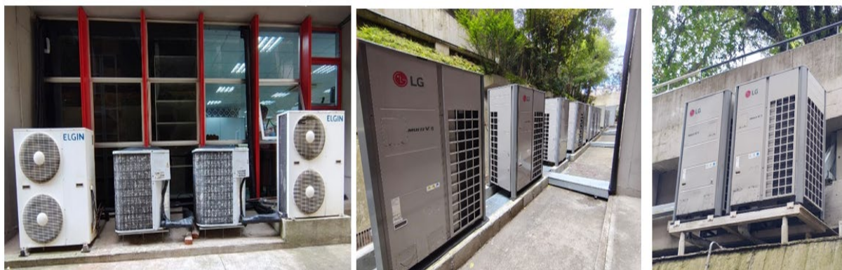
Exemplos de unidades de condensadoras que atendem o Bloco
