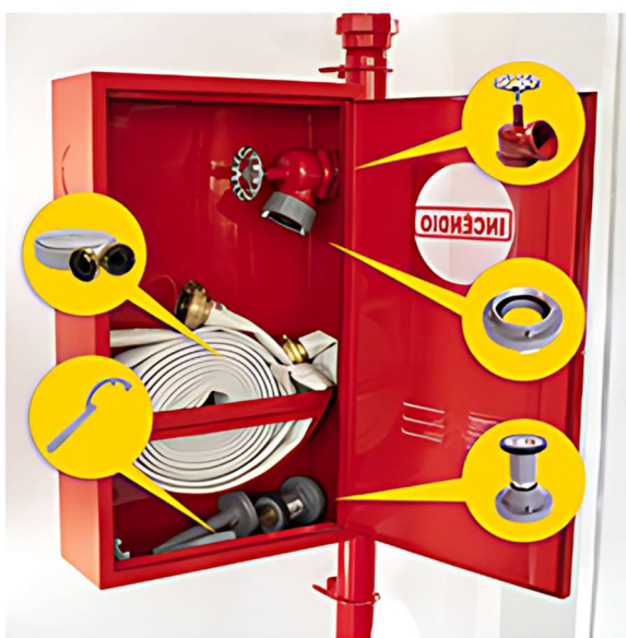
Figura 9: Hidrante com mangueira
