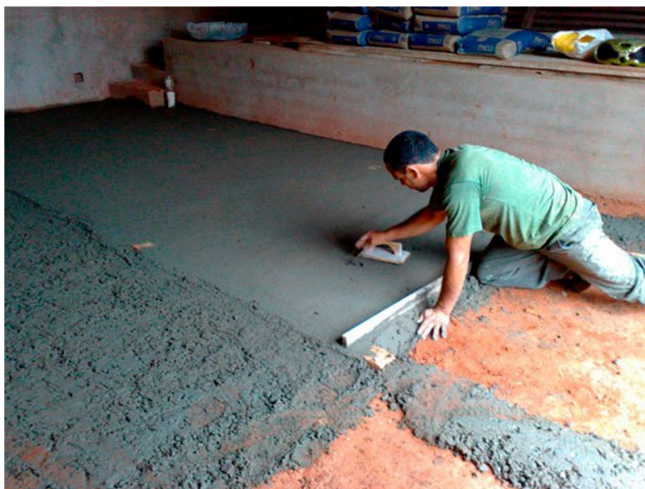
Figura 09 – Execução de contrapiso. Fonte: Portal Metálica.
