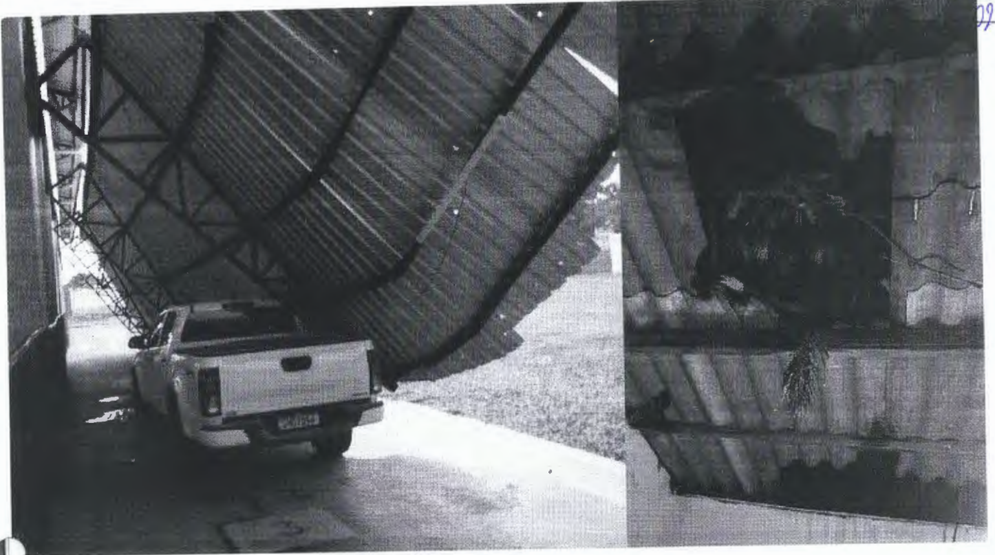
Destruição causada por tempestade em Corumbá. (Foto: Corpo de Bombeiros e Defesa Civil)
