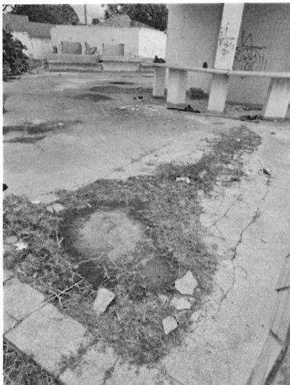
Piso granilite danificado, manchado, demolir e reconstruir
