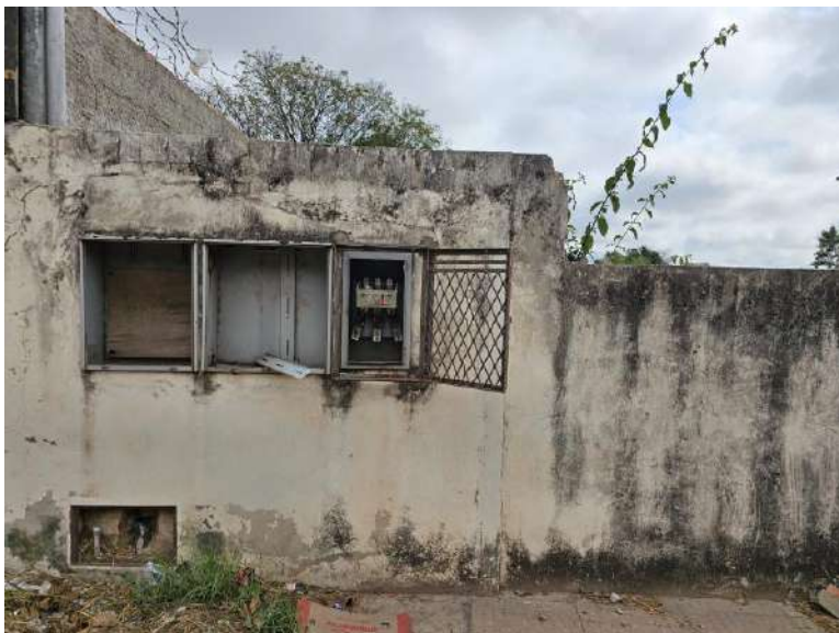
Fachada frontal – mureta entrada de energia danificados e ou com ausência de quadros e fiação elétrica, além do relógio medidor
