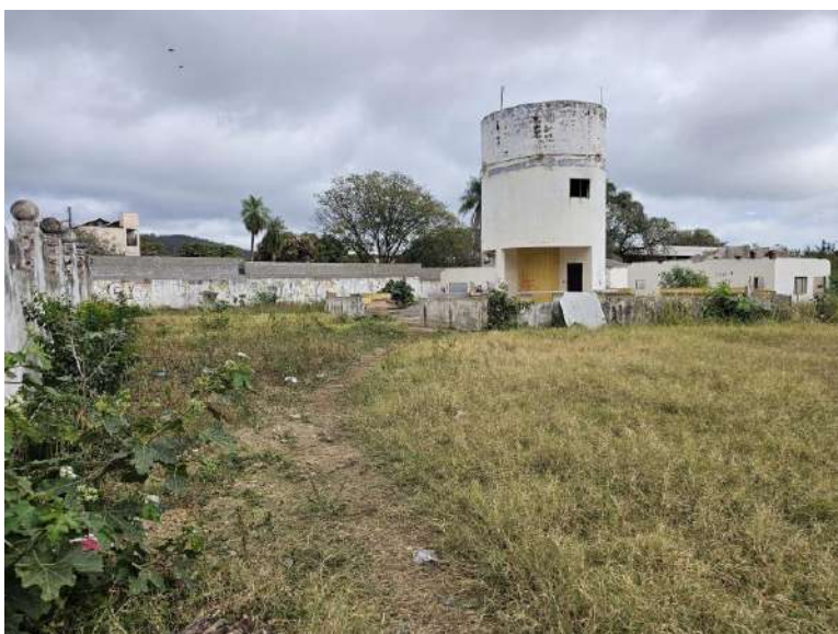
Adentro do terreno, área externa – camada vegetal necessitando roçada e limpeza, piso em lajota sextavada danificado, muro de divisão danificado
