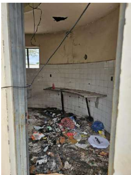
No bloco hexagonal, edificação de formato cilíndrico, em seu interior verificada ausência de elementos de hidráulica, bem com instalações danificadas, ausência de fiação elétrica e seus elementos luminárias, revestimento cerâmico de parede danificados, machados
