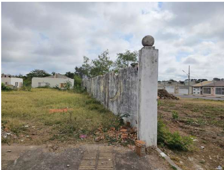
Fachada frontal – muro de divisa danificado, verificado ausência de portões, muro de divisão danificado
