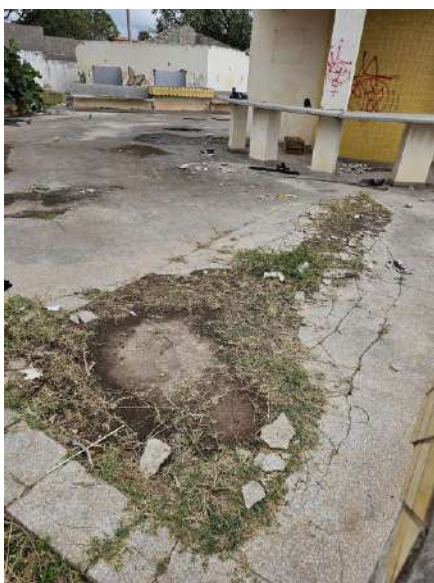
Bloco hexagonal, verificado piso em granilite bastante danificado e machado, contaminado, com trechos trincados
