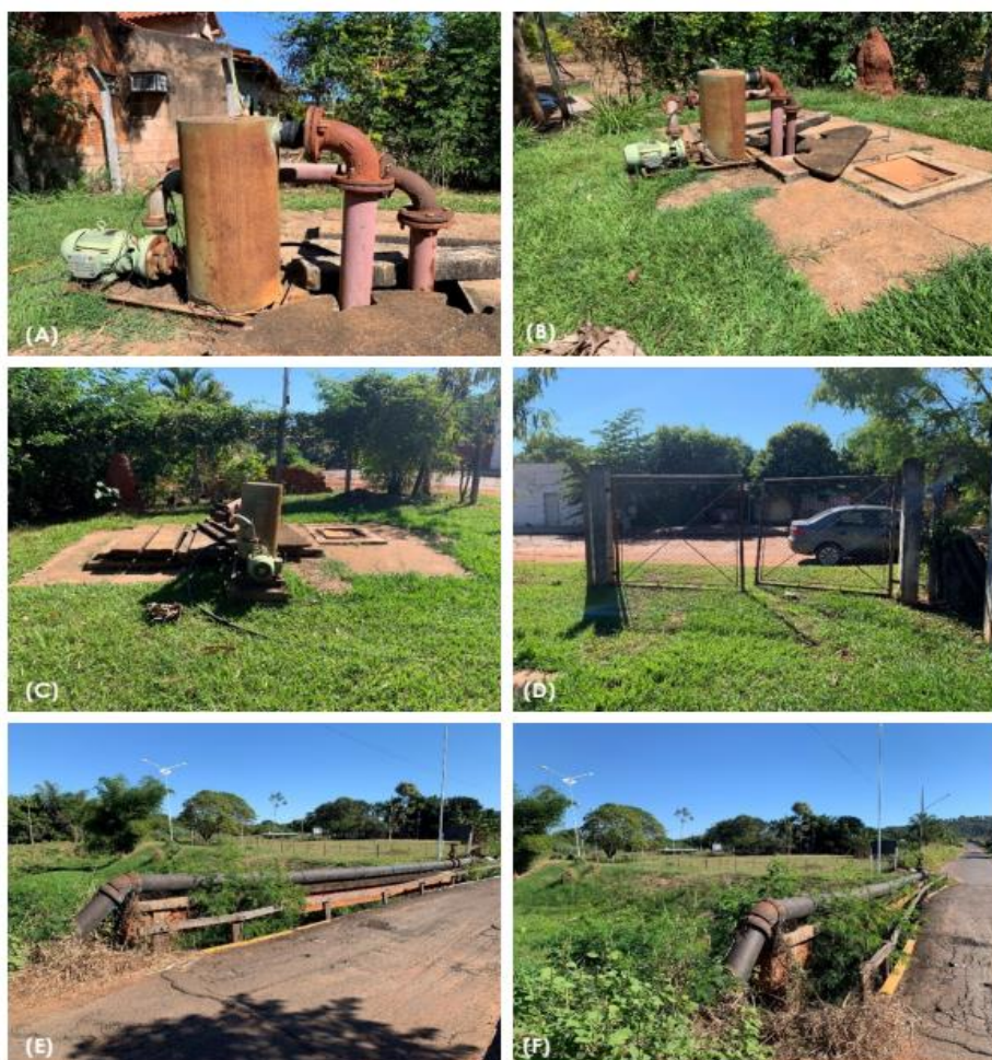
EEEB-01 – Izanópolis: (A), (B) e (C) Elevatório de esgoto bruto que recalca o esgoto coletado para a ETE Saudade; (D) e (E) tronco coletor que transporta o esgoto da EEB-01 para a ETE Saudade.
