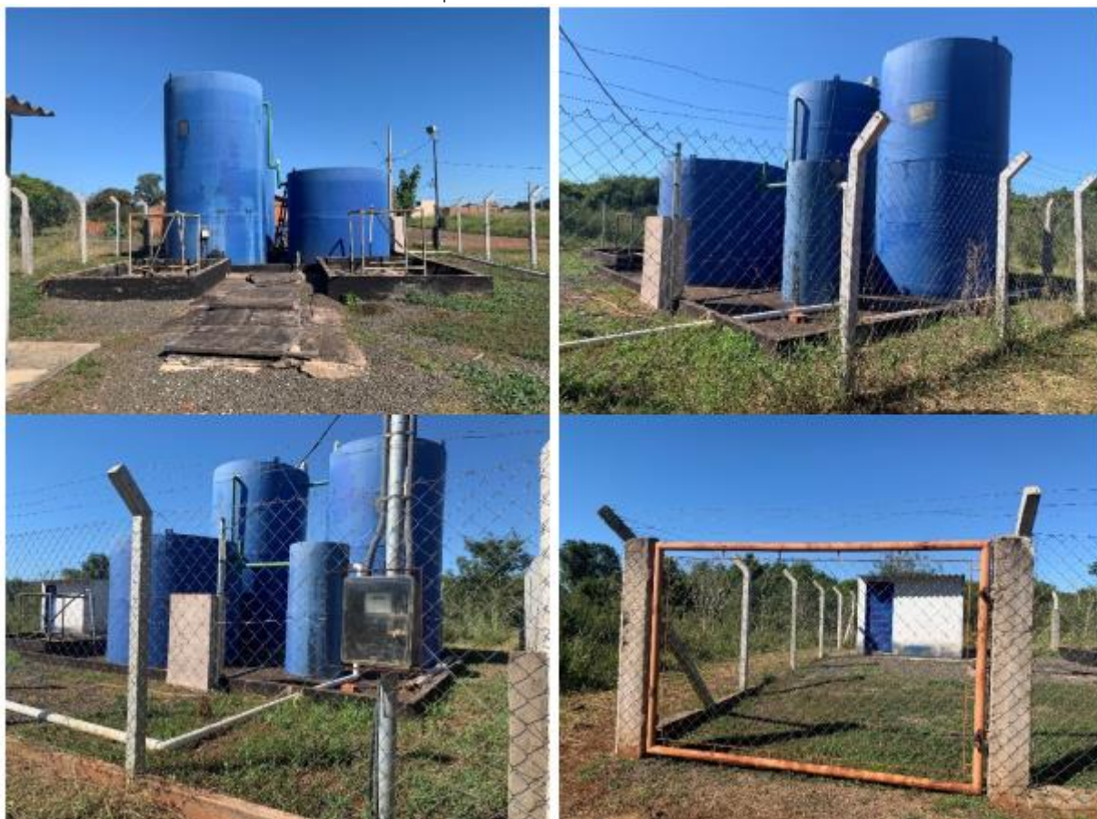
ETE Vale do Aporé: Sistema compacto composto por 2 (dois) Reatores Aerados, 1 (um) Decantador e sistema de desinfecção por hipoclorito.
