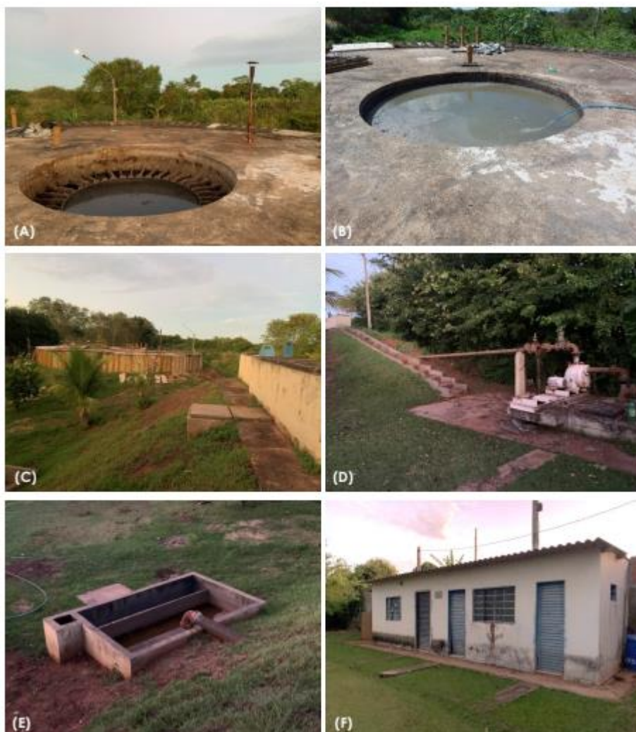
ETE Juracy Lucas: (A) e (B) Reator Anaeróbico de Lodo Fluidizado (RALF), com destaque à adição de água no registro (B); (D) EEBB que recalca o efluente bruto coletado para o tratamento preliminar; (E) Desarenador e (F) Almojarifado.
