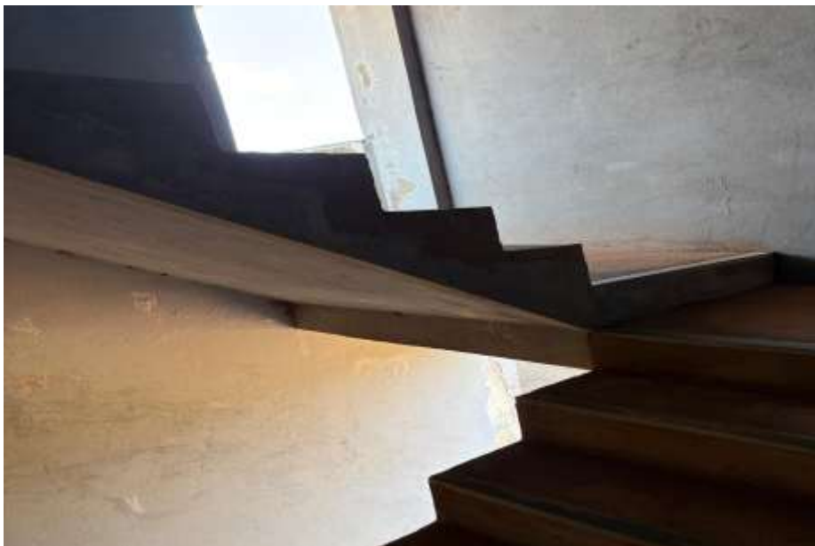
Vista 8 - Lance de escada sem corrimão e guarda corpo.
