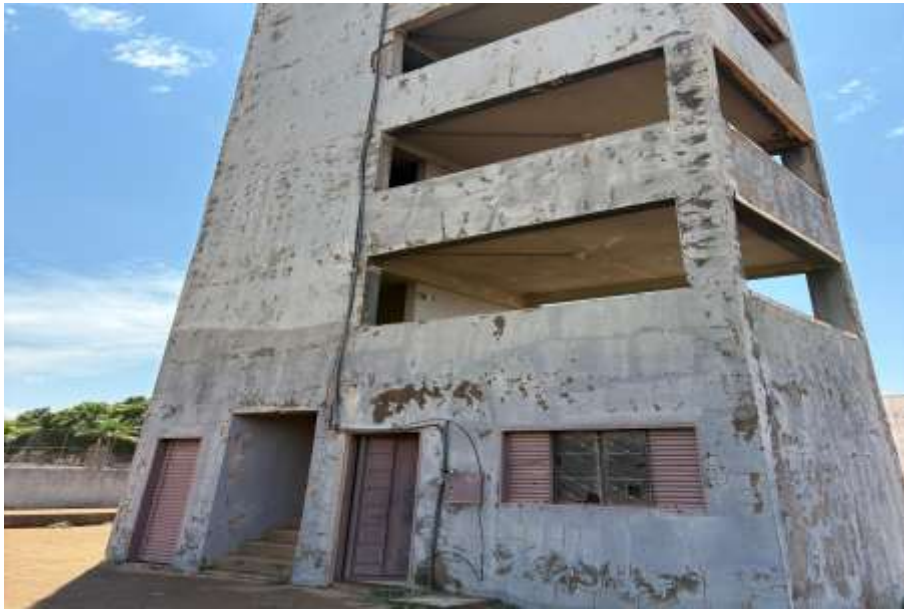
Vista 3- Fachada da escada com patologias em paredes e esquadrias com deterioração da pintura.
