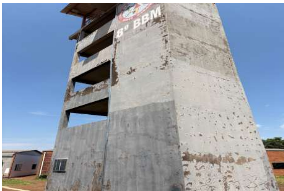
Vista 6 - Vista lateral da torre evidenciando deteriorização da pintura e reboco.
