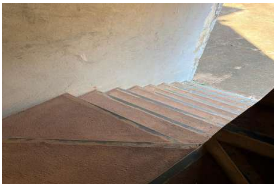
Vista 10- Condição inicial dos degraus e patamares sem corrimão e guarda corpo.
