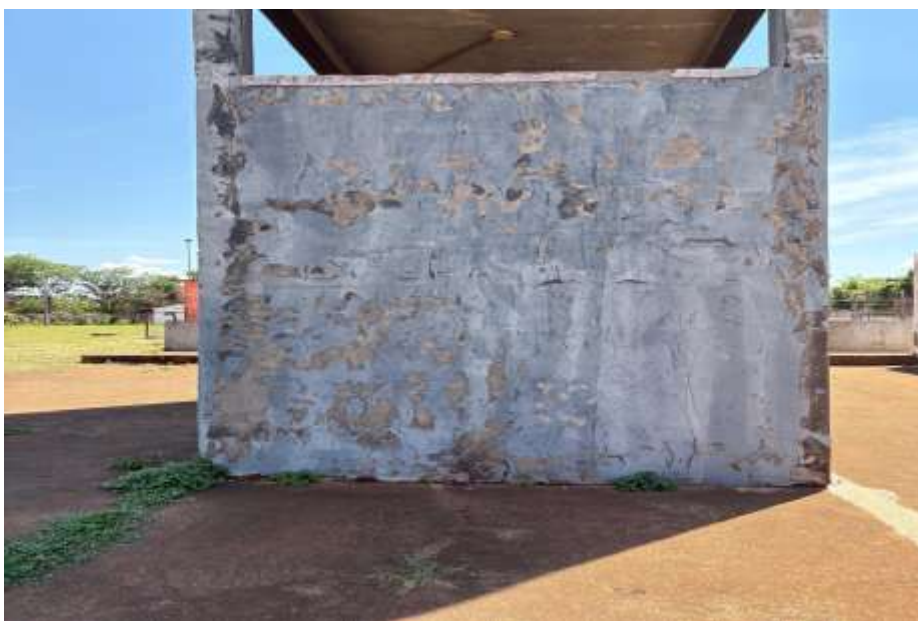
Vista 2 - Vista externa do primeiro piso apresentando desgaste de revestimento.
