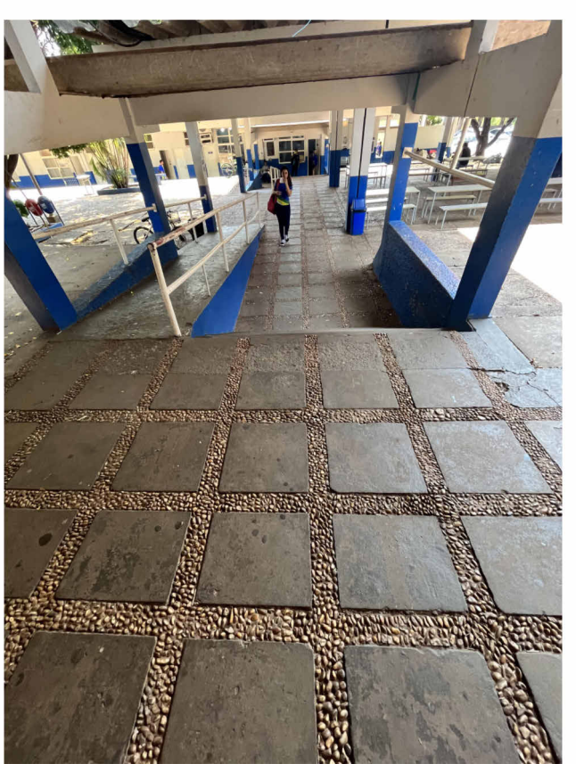
CIRCULAÇÃO: PREVER DEMOLIÇÃO DAS RAMPAS E ESCADAS, POIS NÃO ATENDEM AS NORMAS DE ACESSIBILIDADE.
