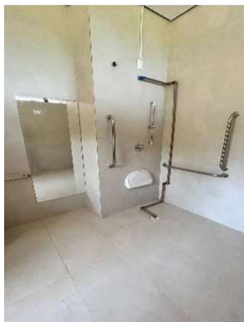
Imagem 08: Tubulação a ser embutida na parede, ausência de chuveiro.
