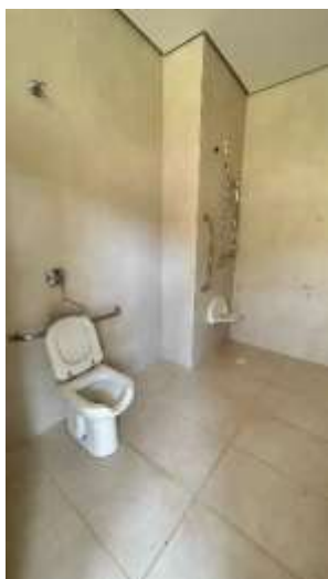
Imagem 10: Ausência barra de apoio chuveiro.
