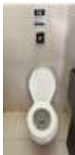
Imagem 04: Ausência acabamento válvula hydra
