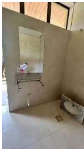
Imagem 14: Bancada quebrada no ambiente.
