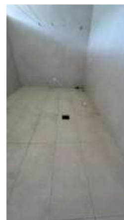
Imagem 16: Ausência acabam. ralo.
