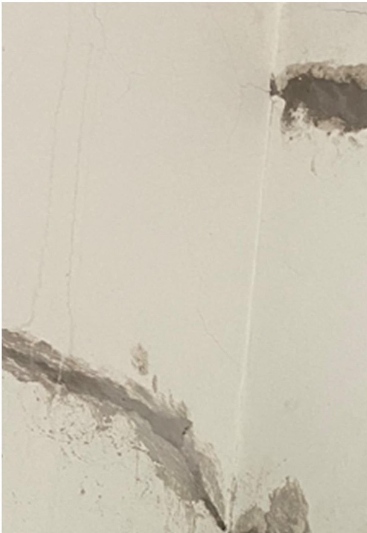
Fissura na alvenaria Fissura na alvenaria
