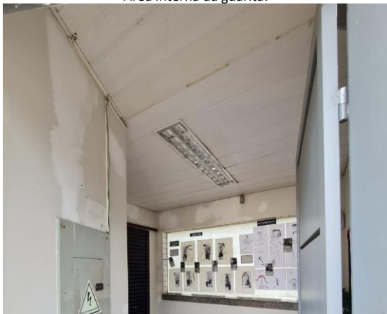
Luminárias existentes de lâmpadas tubulares a serem retiradas.
