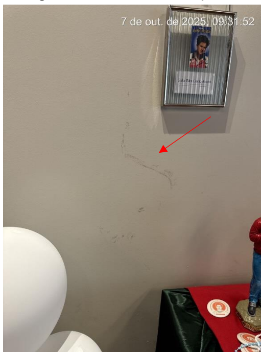
Figura 18 – Marcas nas paredes
