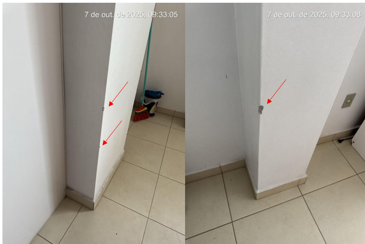
Figura 21 – Batidas nos cantos dos pilares
