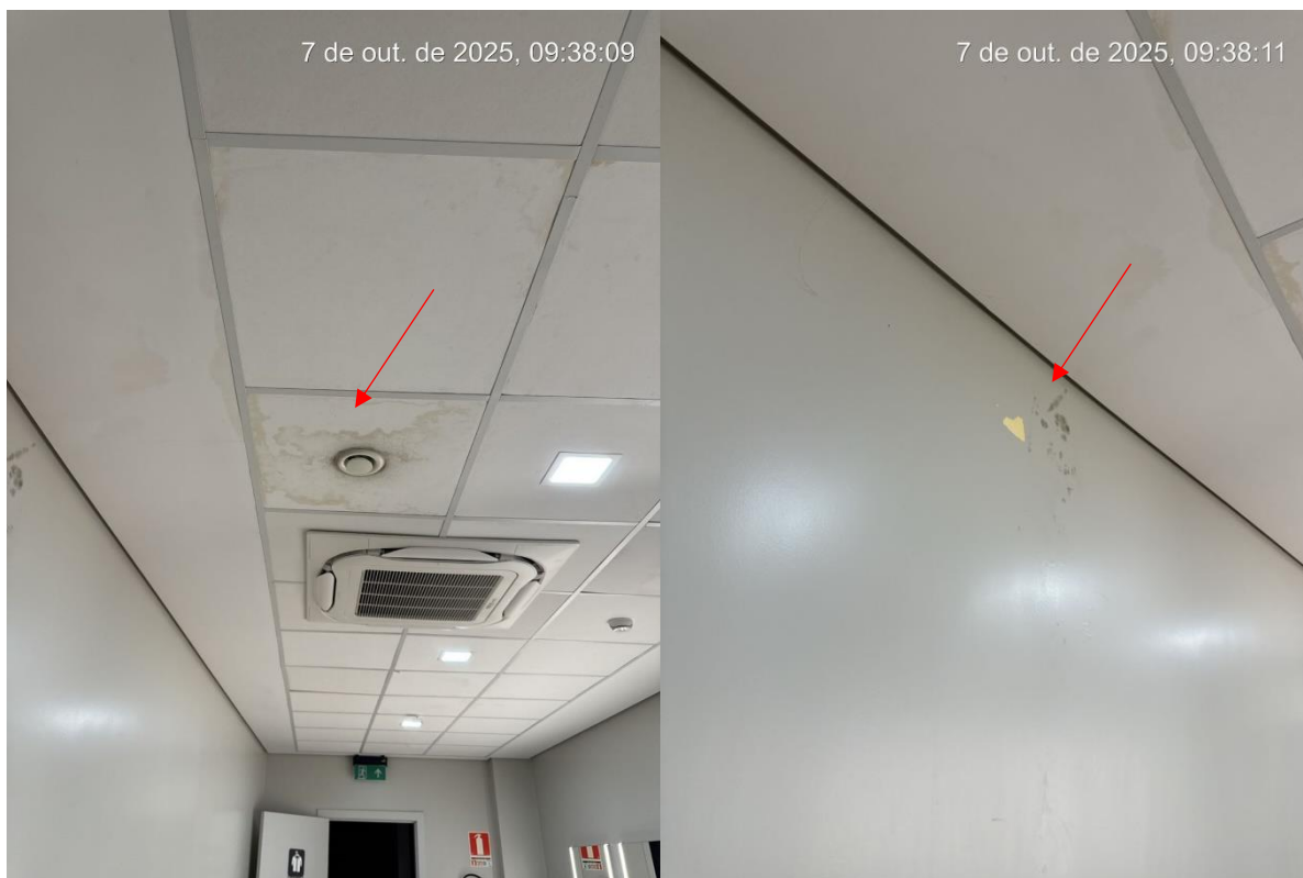
Figura 12 – Pontos de infiltração no camarim 1
