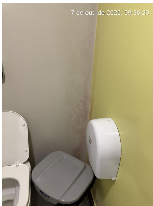
Figura 8 – Presença de infiltração
