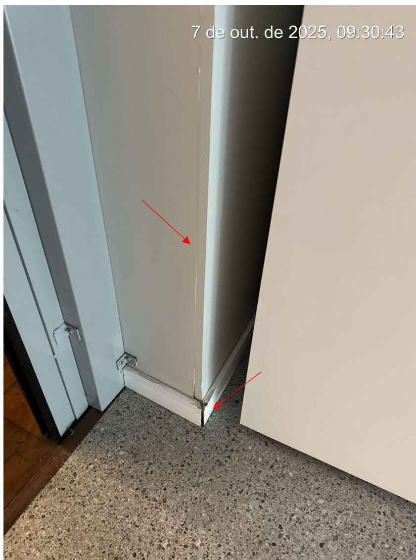
Figura 3 – Rodapé danificado e marcas na paredes
