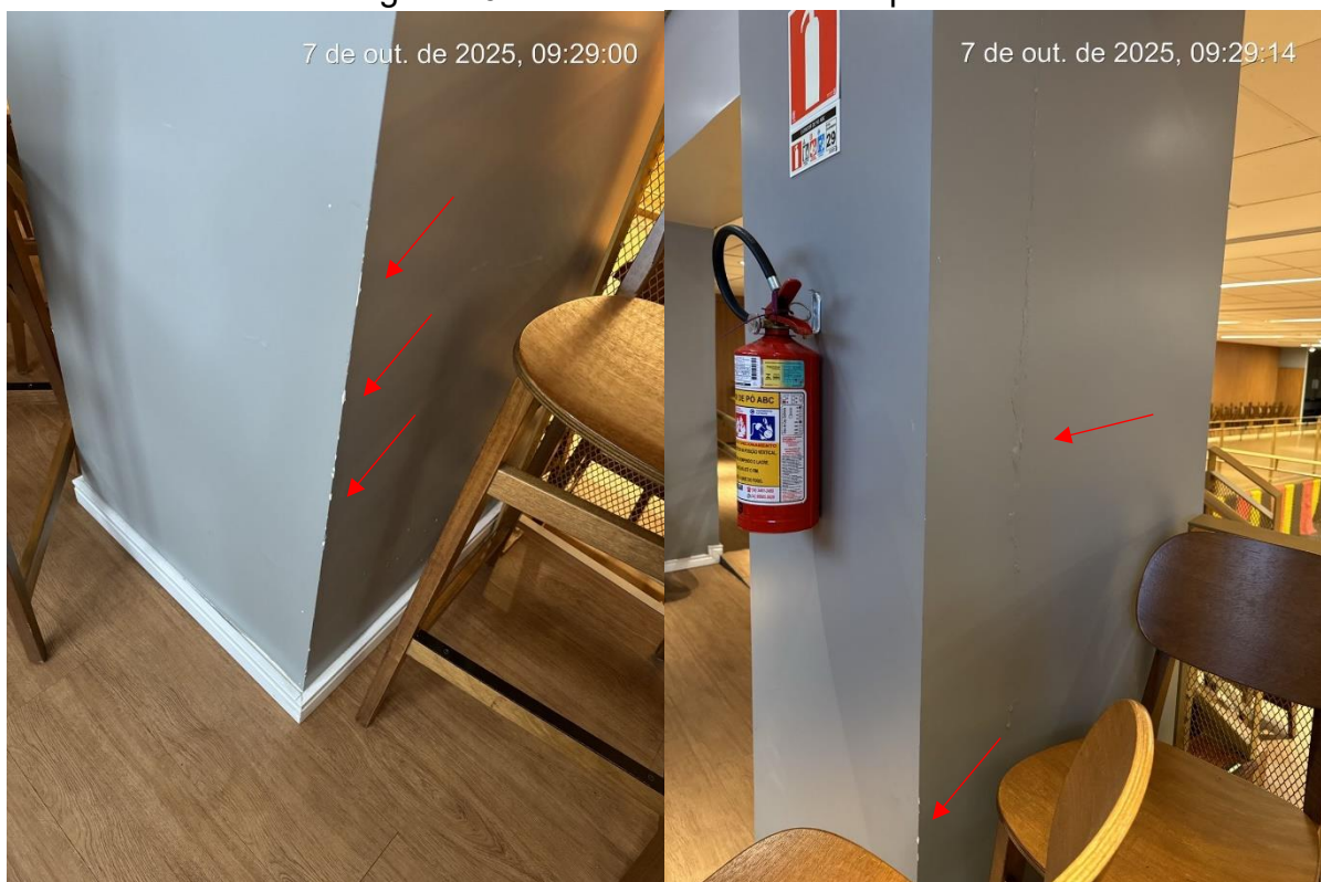
Figura 16 – Batidas e marcas nos pilares
