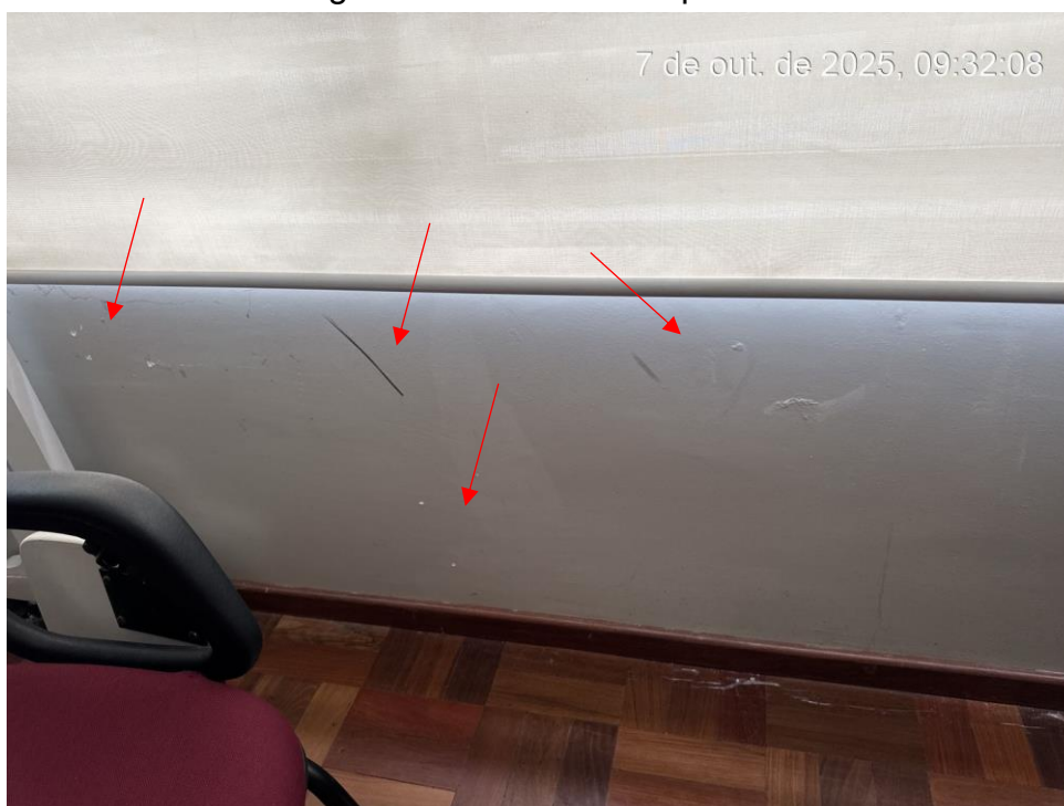
Figura 19 – Marcas nas paredes
