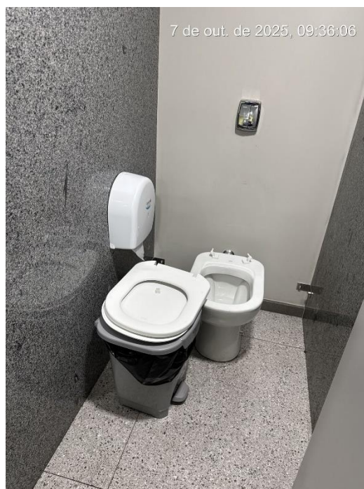
Figura 9 – Assento sanitário desinstalado ou quebrado
