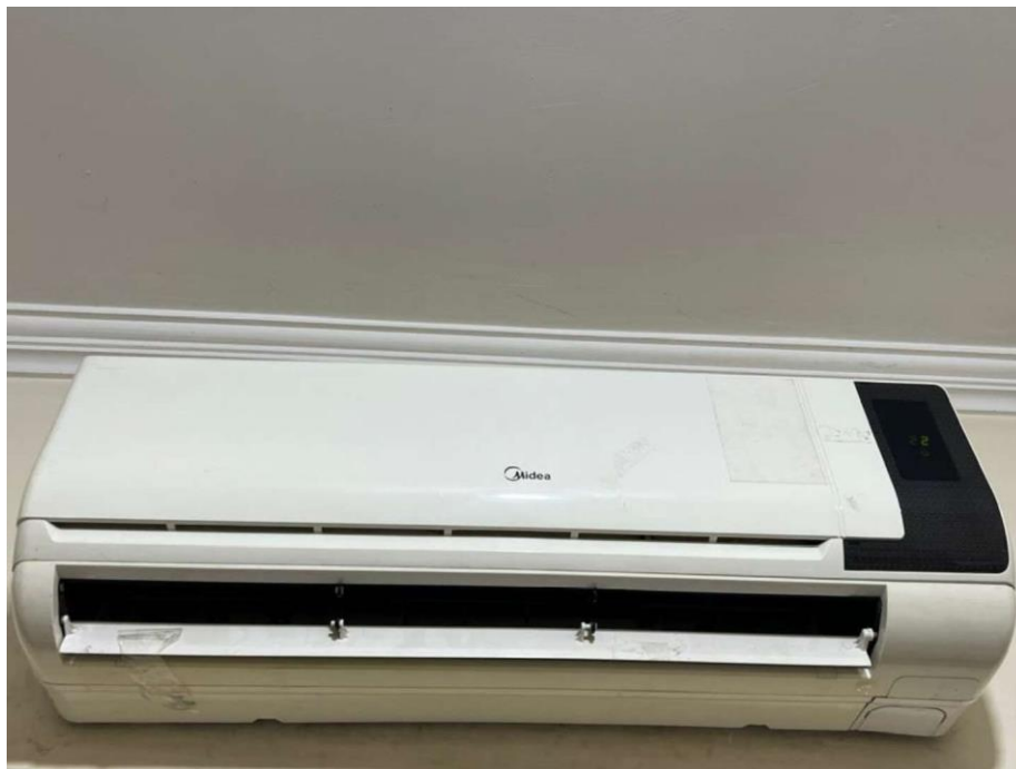
Foto 7 – Central de Ar Setor de Registro Ar condicionado 9.000 Btu's
