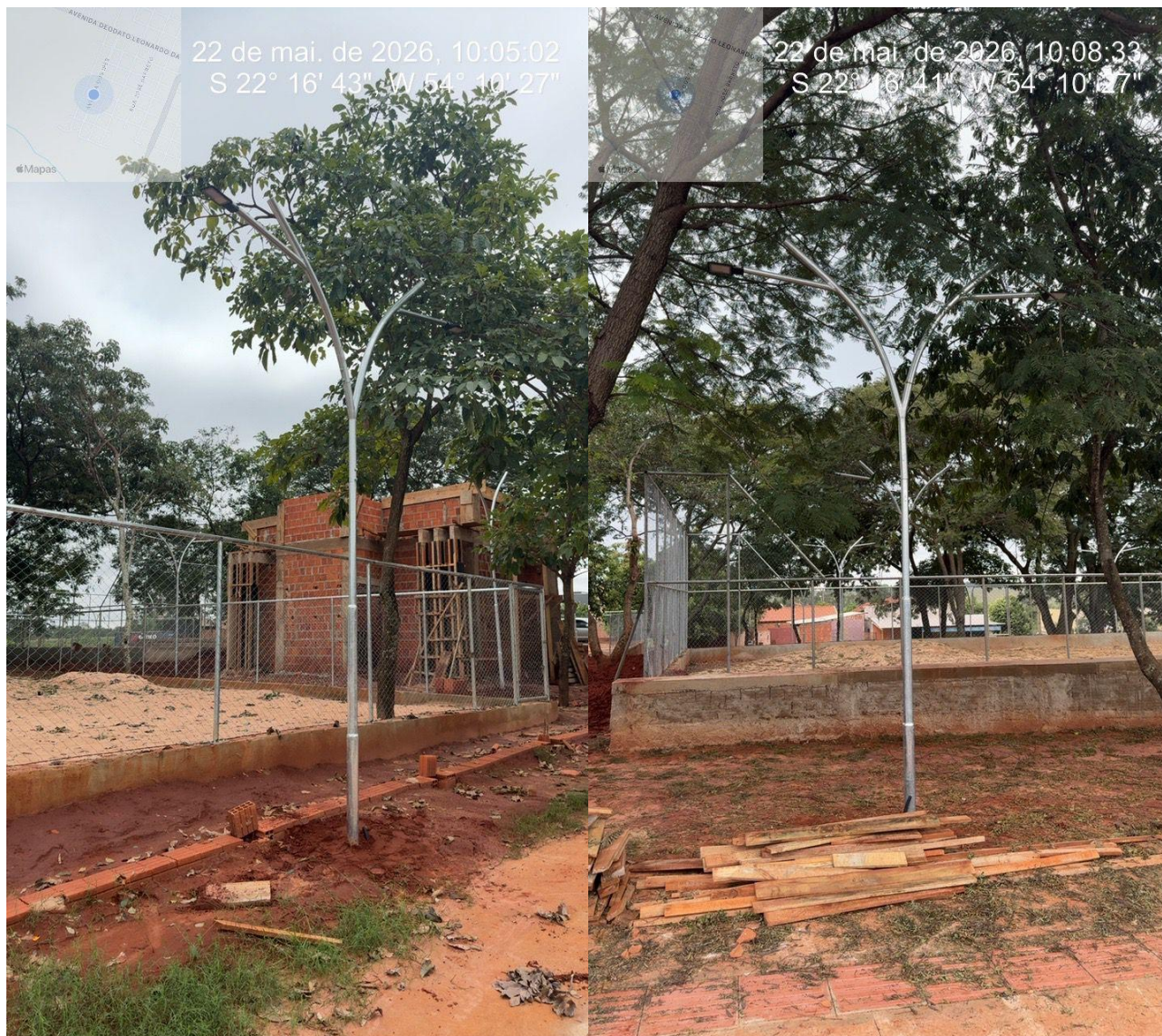
Imagens 28 e 29 – Postejamento de iluminação pública: Acervo próprio.
