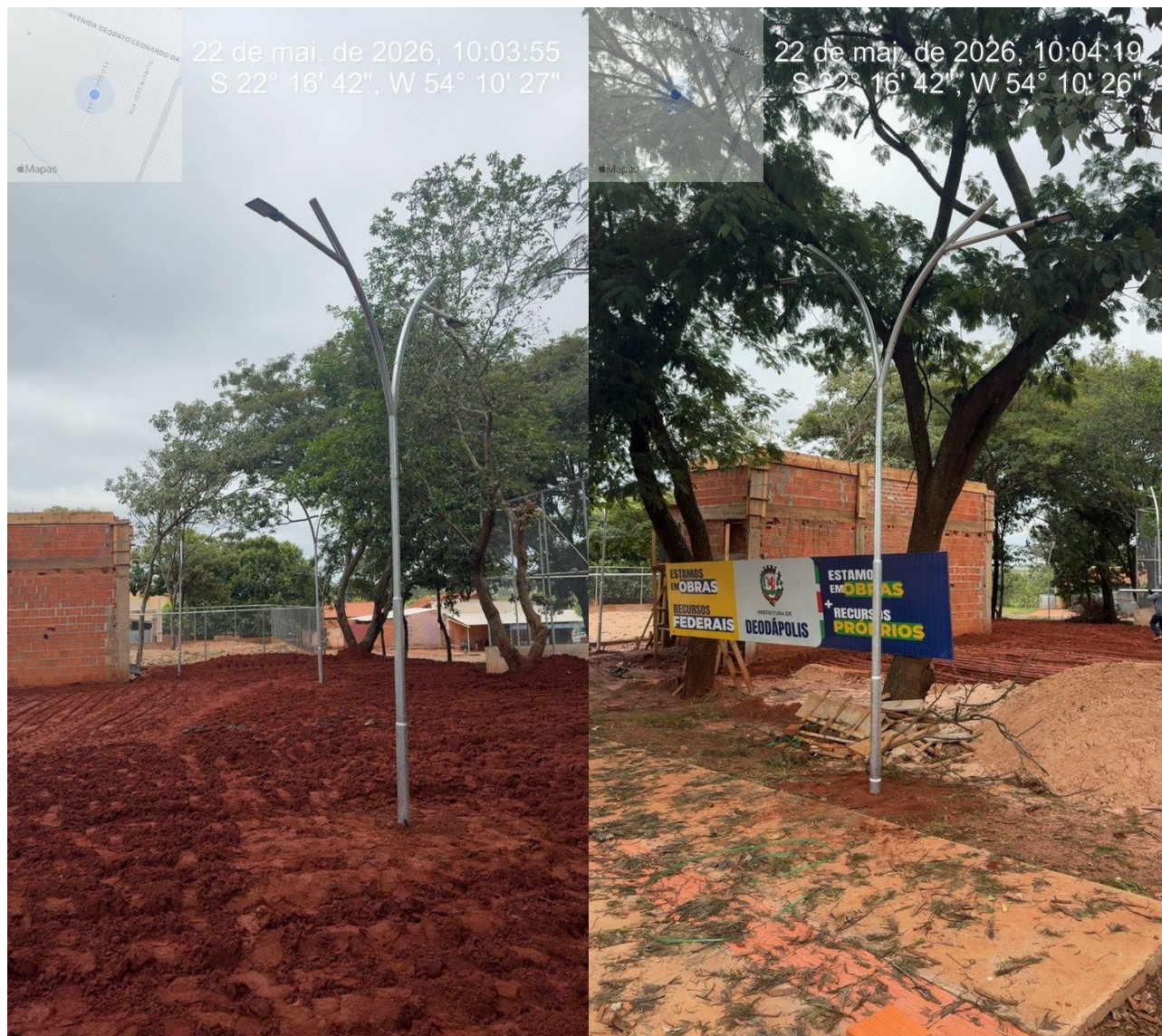
Imagens 26 e 27 – Posteamento de iluminação pública: Acervo próprio.
