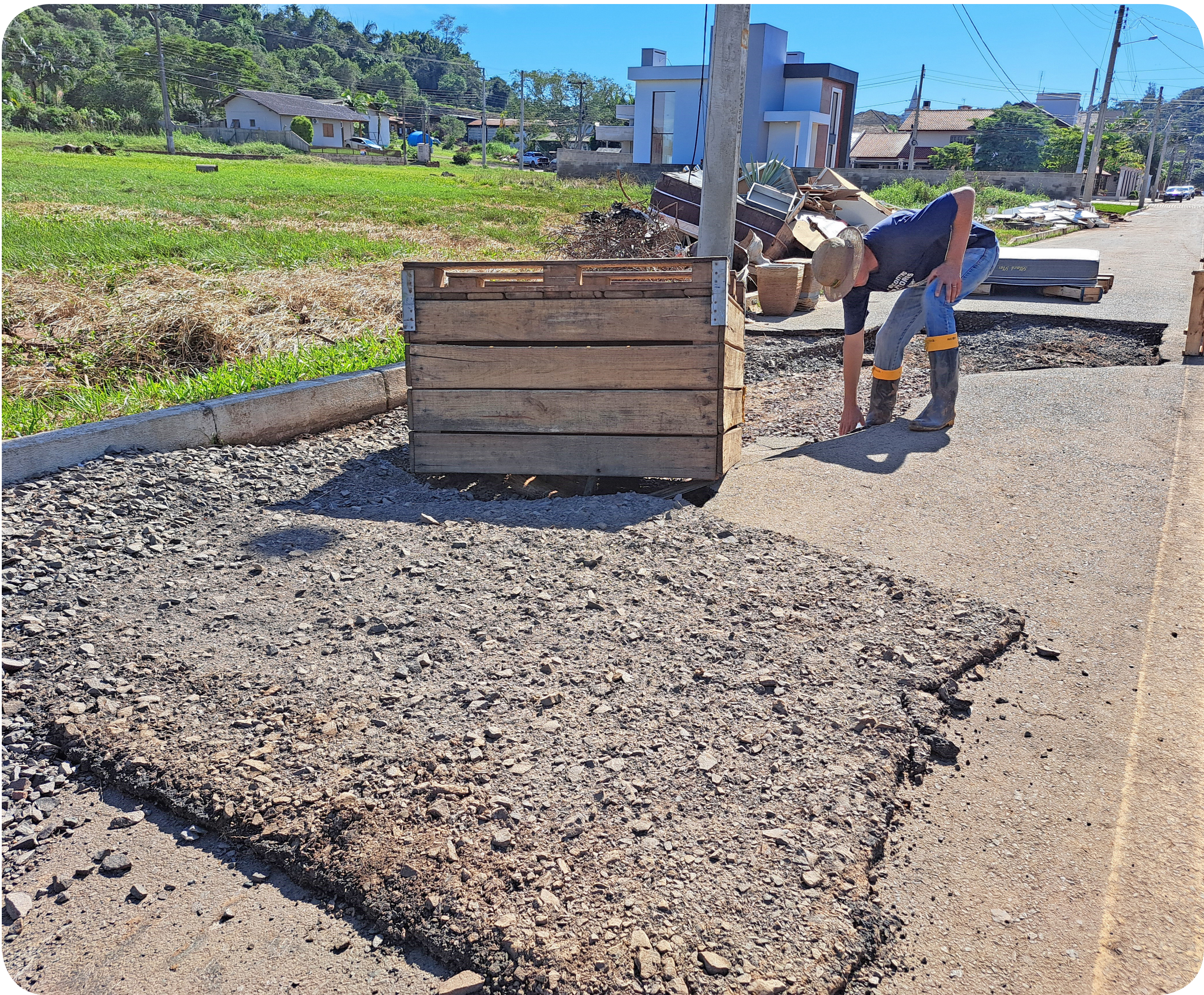
Na cidade há trechos em que o asfalto foi arrancado em grandes blocos pela correnteza
