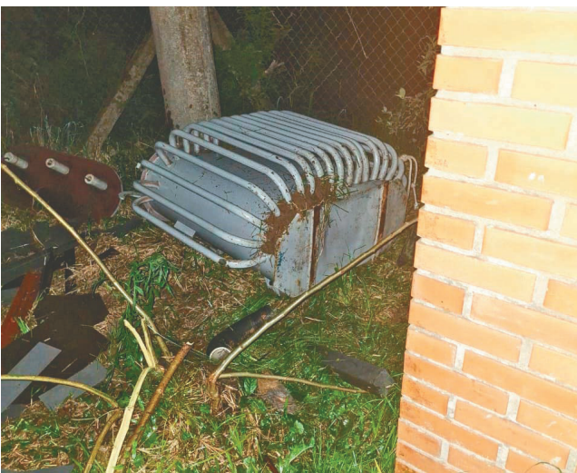
Transformador foi derrubado durante a ação criminosa
