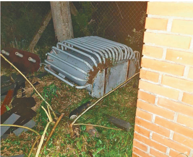
Transformador foi derrubado durante a ação criminosa
