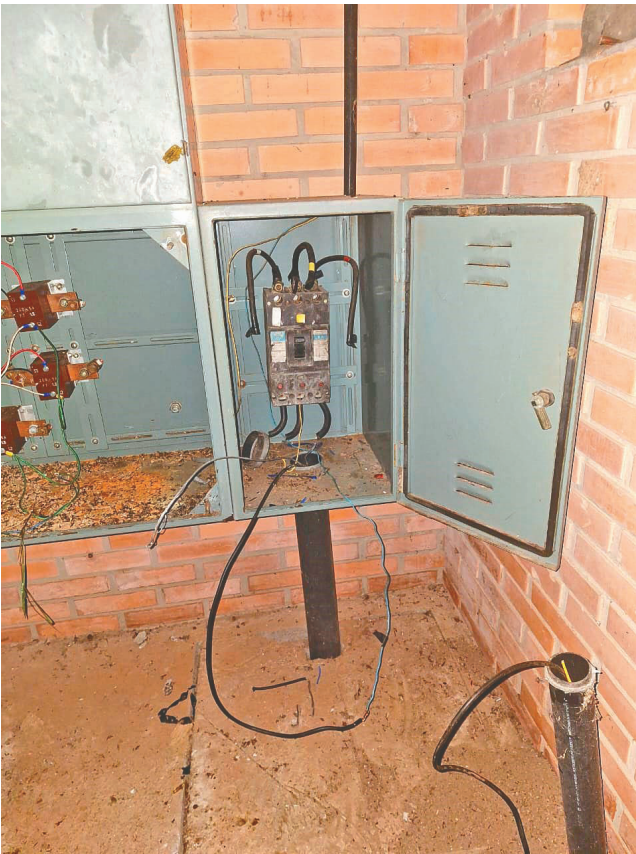
Cabos de luz foram furtados no recalque junto à captação de água do Rio Caí, no município de Triunfo
