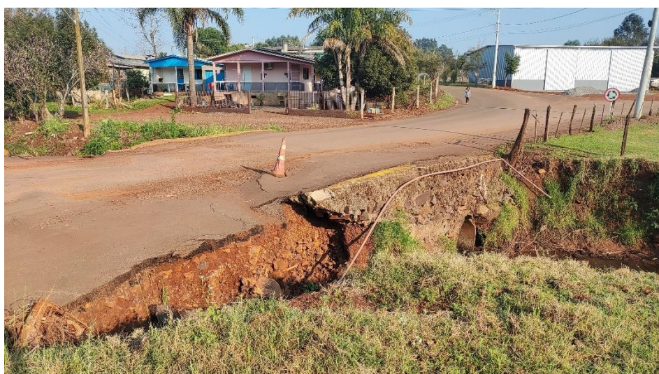
Figura 3: Vista da ponte danificada
