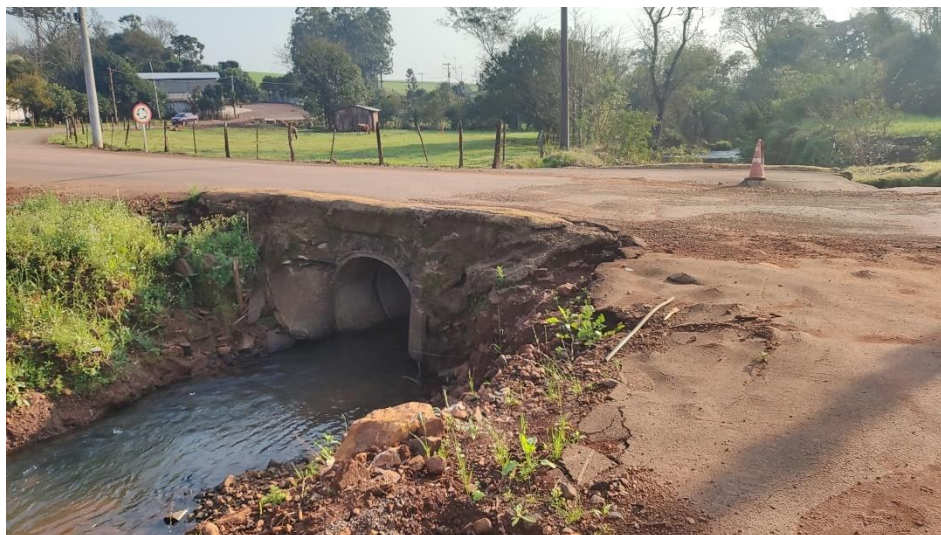
Figura 4: Vista da ponte danificada
