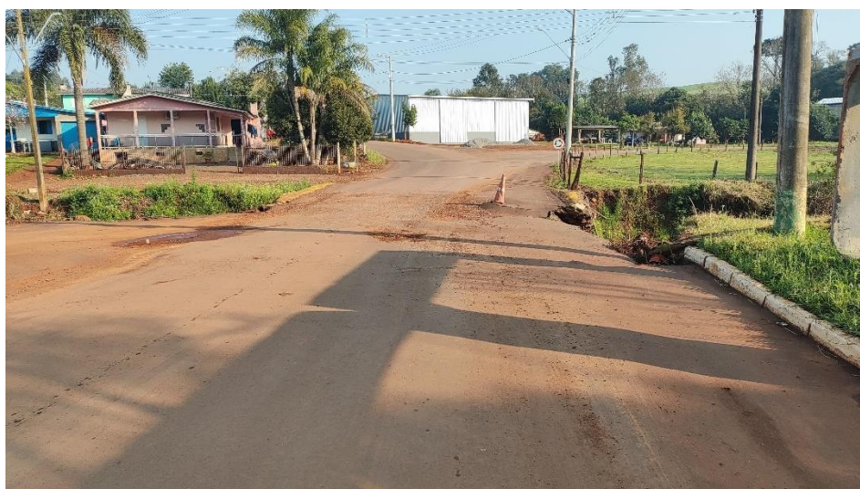
Figura 2: Vista da ponte danificada
