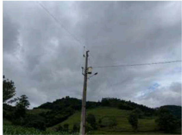
Figura 5: Rede elétrica para ligação.
