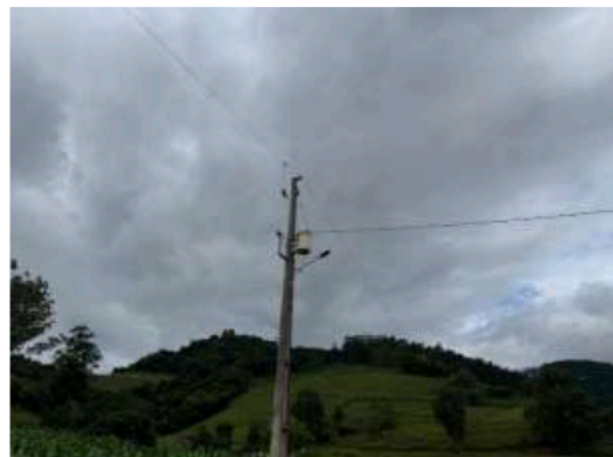
Figura 3: Rede elétrica para ligação.
