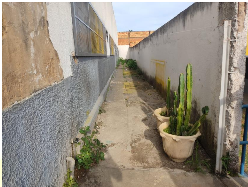
Figura 4 – Piso de concreto e muro a serem demolidos
