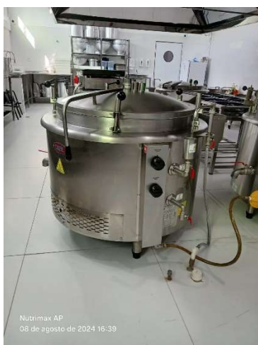
Figura 36 - Caldeirão a gás tampa autoclavada
