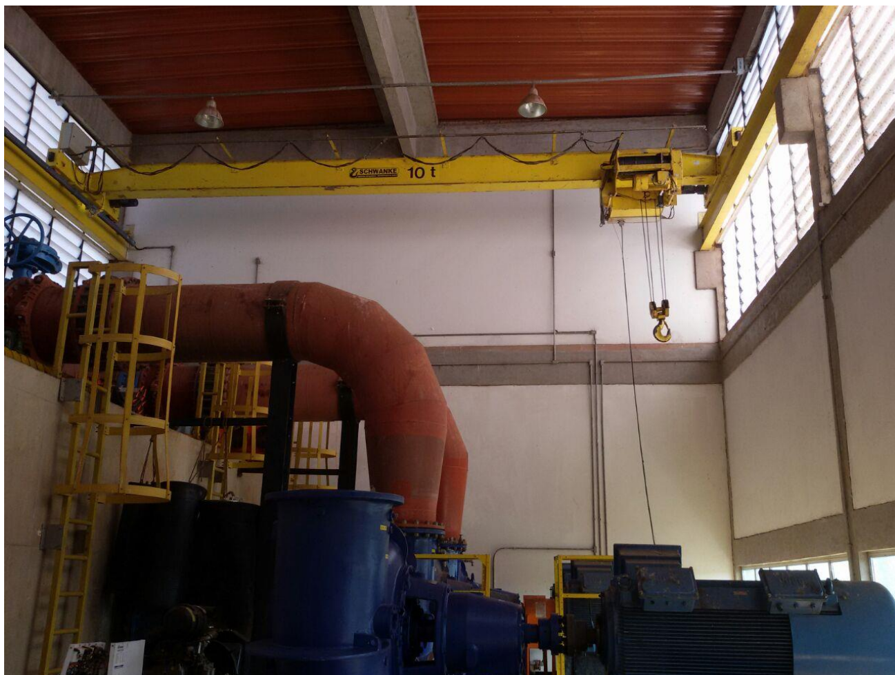
Figura 2 - Foto referente a ponte rolante univiga apoiada - Casa de Recirculação de Lodo
