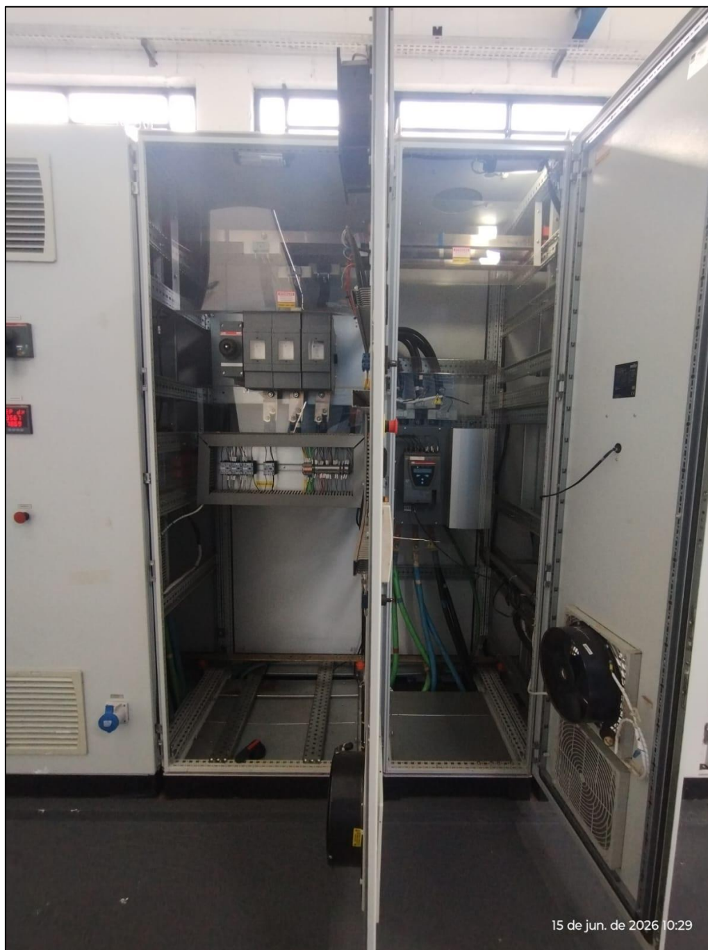
Figura 8 - Módulo de seccionamento e acionamento
