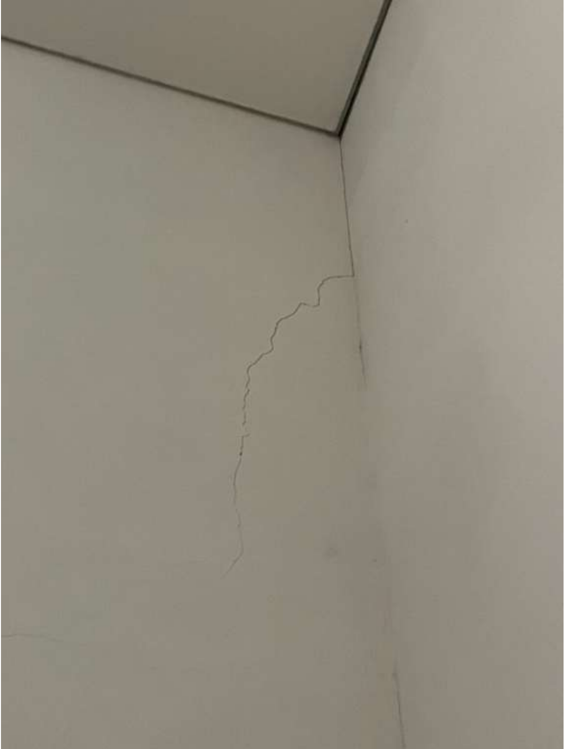
Figura 6 – Fissuras identificadas em parede interna.
