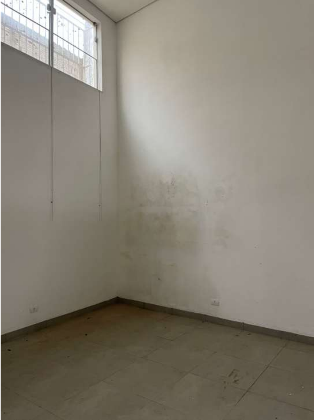
Figura 4 – Pontos de umidade e manchas em parede interna.
