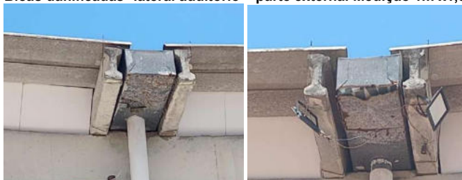
Bicas danificadas- lateral auditório – parte externa. Medição 1m x1,50m
