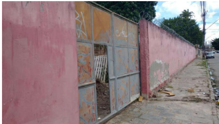
Muro parte externa do 2ºBBM (Rua: Major Belmiro) Medição: 60m de extensão por 2,5m de altura
