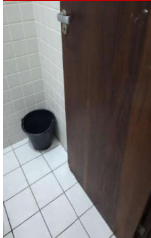
Porta Aloj CSU danificada - 70cm
