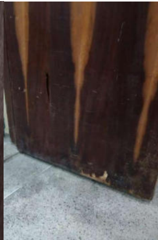
Porta Sala Chefe CAT danificada 70cm
