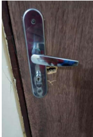
Portas CAT danificada 80cm
