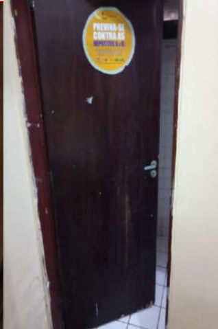
Porta Banheiro CSU danificada 70cm
