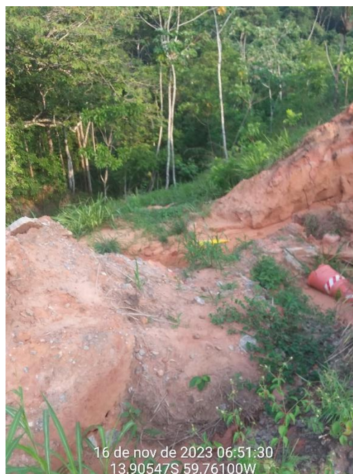
FIGURA 4 – PROCESSO EROSIVO LOCALIZADO NO LADO ESQUERDO DO SENTIDO CRESCENTE -KM 472,10 BR-174
