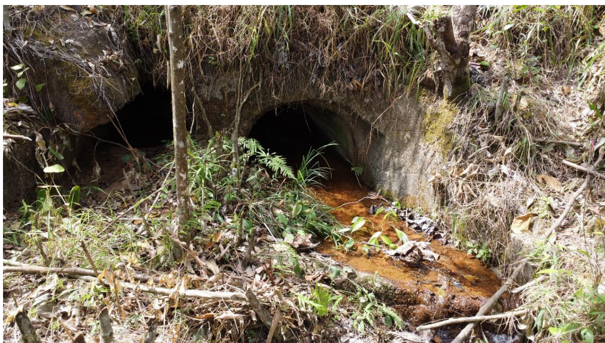
FIGURA 5 – BUEIRO RECALCADO NECESSITANDO SUBSTITUIÇÃO
