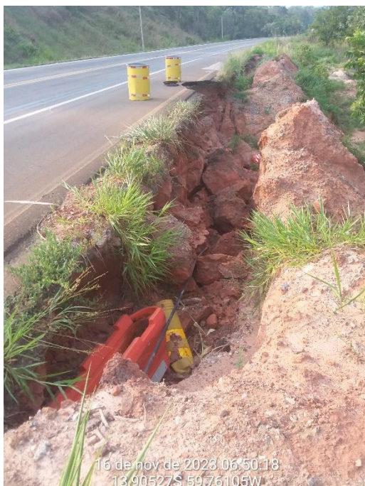
FIGURA 1 – PROCESSO EROSIVO LOCALIZADO NO LADO ESQUERDO DO SENTIDO CRESCENTE -KM 472,10 BR-174
