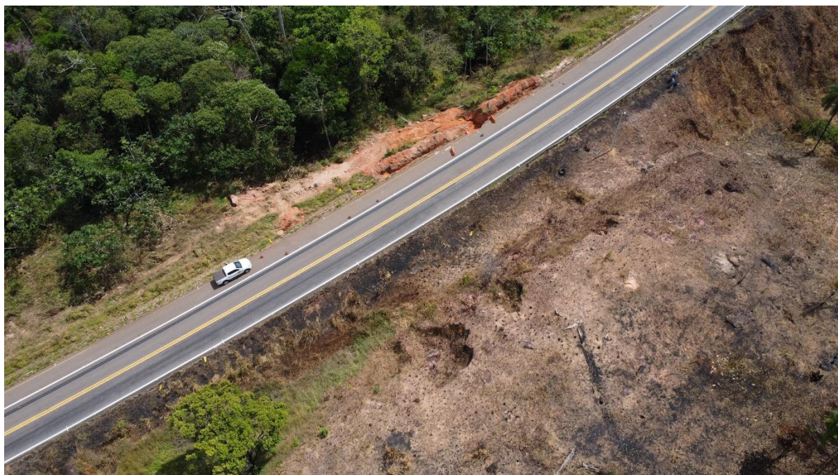
FIGURA 9 – LOCAL DO PROCESSO EROSIVO KM 472,10, CORPO DO ATERRO EM AMBOS OS LADOS PRÓXIMO DO CORPO ESTRADAL NECESSITANDO DE RECOMPOSIÇÃO.
