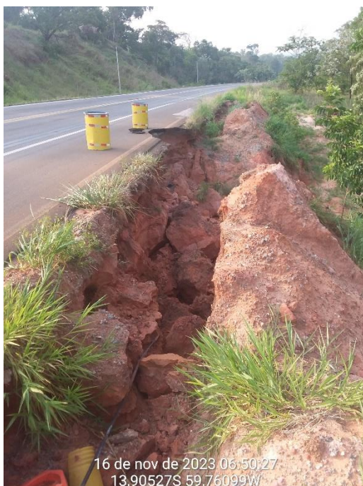
FIGURA 3 – PROCESSO EROSIVO LOCALIZADO NO LADO ESQUERDO DO SENTIDO CRESCENTE -KM 472,10 BR-174
