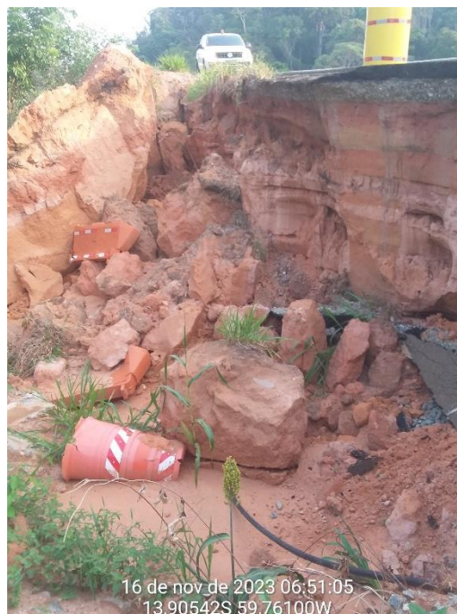
FIGURA 2 – PROCESSO EROSIVO LOCALIZADO NO LADO ESQUERDO DO SENTIDO CRESCENTE -KM 472,10 BR-174
