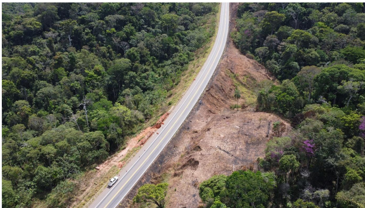
FIGURA 10 – LOCAL DO PROCESSO EROSIVO KM 472,10, CORPO DO ATERRO EM AMBOS OS LADOS PRÓXIMO DO CORPO ESTRADAL NECESSITANDO DE RECOMPOSIÇÃO.
