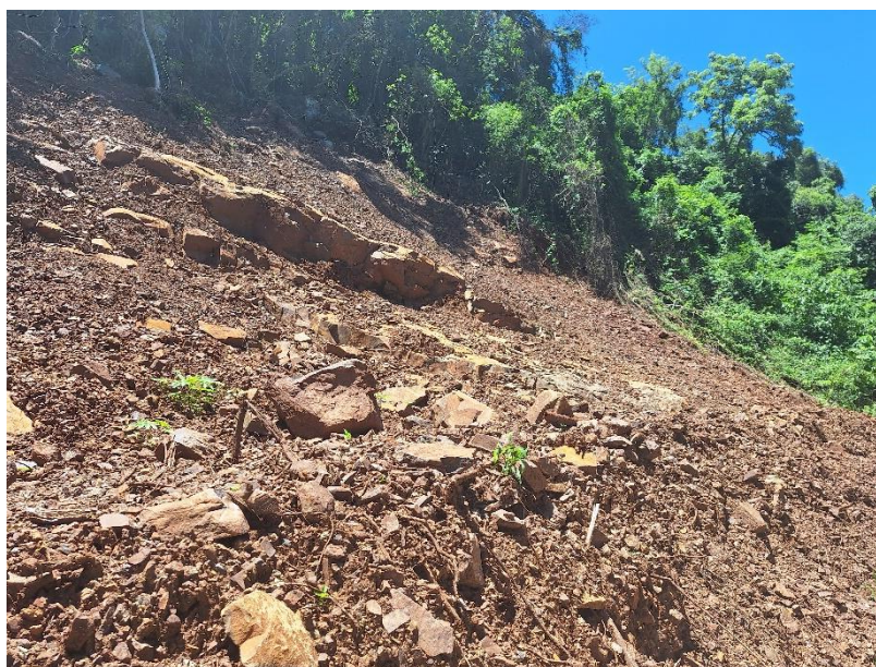
Figura 15 - km 203+000 – Blocos aparentes na região da ruptura.
