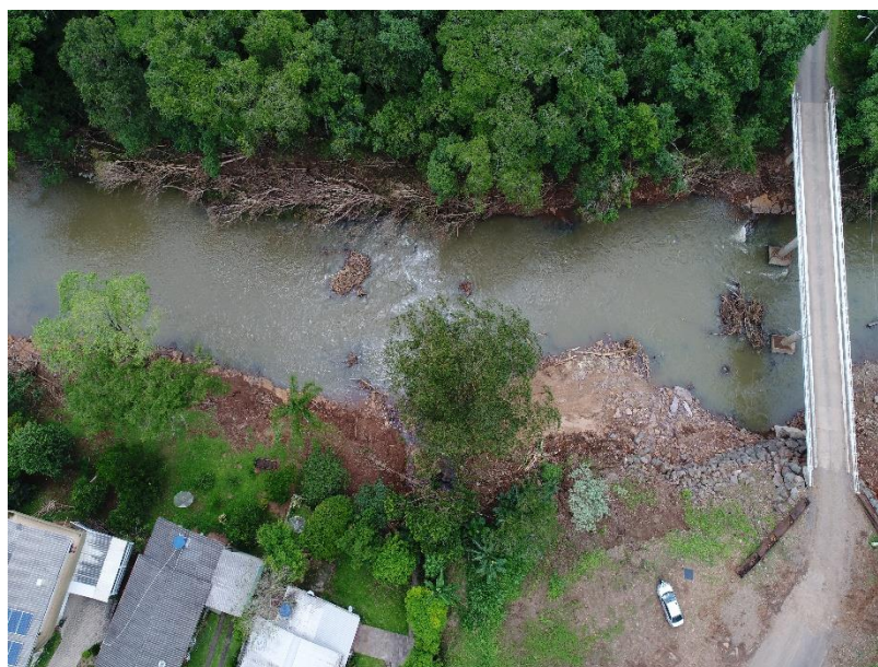
Figura 10 - km 195+500 – Vista superior da região rompida.
