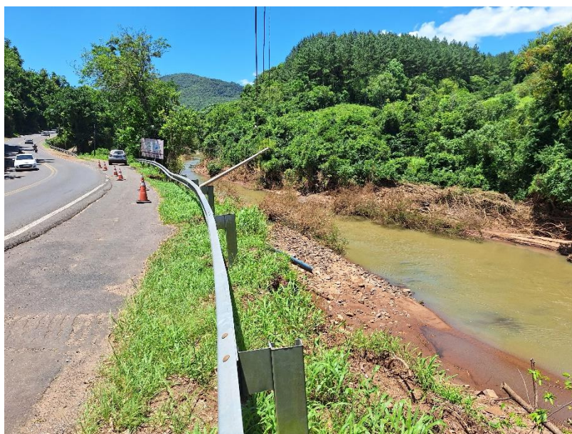
Figura 8 - km 195+500 – Vista lateral do talude rompido.
