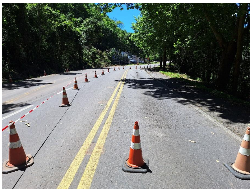
Figura 2 - km 191+000 – Região afetada pelo rebaixamento e trinca do pavimento.
