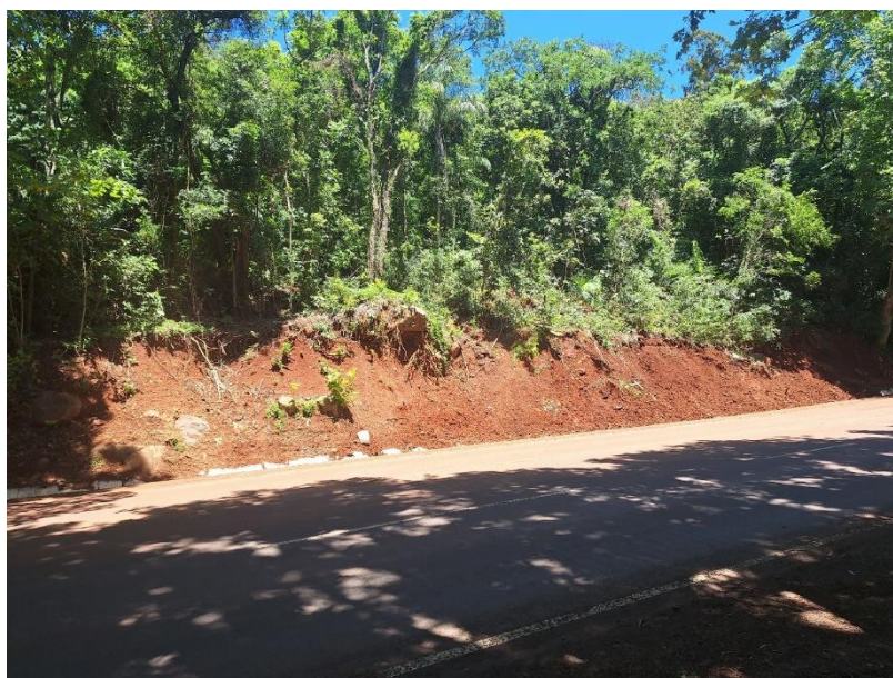
Figura 17 - km 219+000 – Pequeno talude de montante rompido com presença de blocos na crista.
