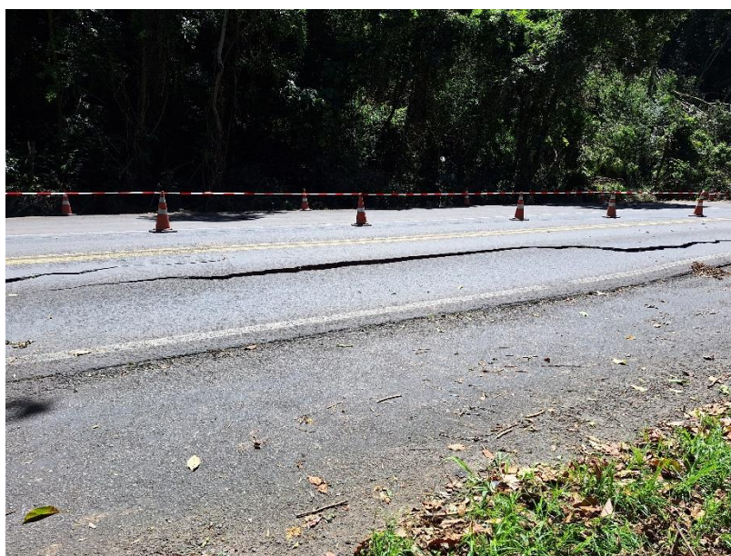
Figura 3 - km 191+000 – Abertura de trinca longitudinal a pista, com rebaixamento acentuado.
