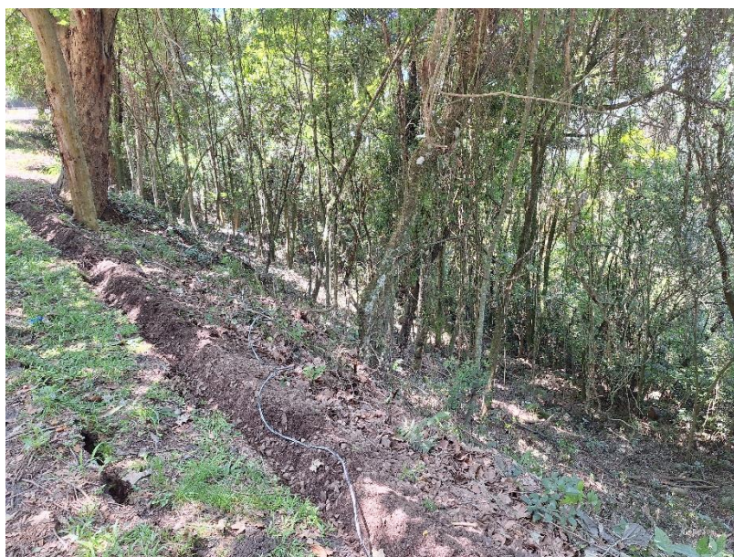
Figura 6 - km 191+000 – Trincas no solo do talude de jusante.
