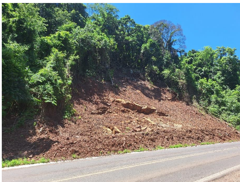
Figura 15 - km 203+000 – Ruptura no talude a montante.
