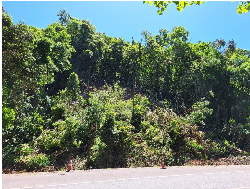
Figura 4 - km 191+000 – Ruptura de talude a montante.
