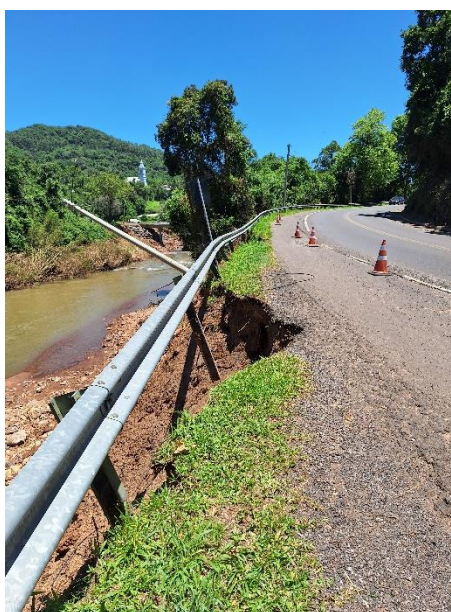
Figura 7 - km 195+500 – Ruptura do talude a jusante atingindo o acostamento e defesa.
