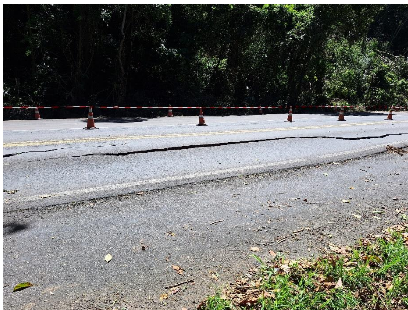
Figura 5 – Movimento de solo com abertura de trincas com rebaixamento do pavimento no km 191+000.
