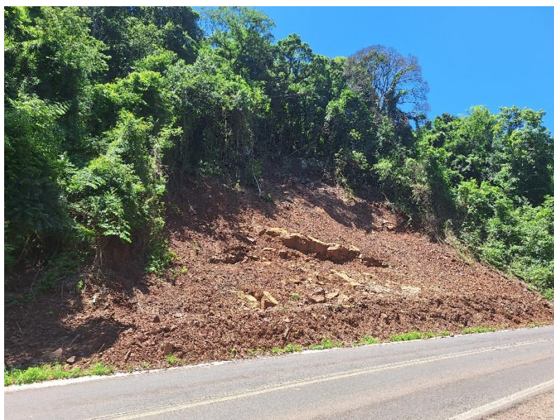
Figura 7 – Ruptura em talude de montante do km 203+000.
