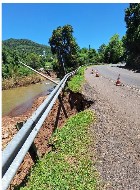
Figura 6 – Erosão no talude de jusante do km 195+500, atingindo acostamento e defesa.
