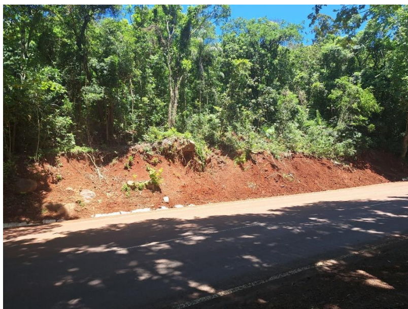
Figura 8 – Ruptura em talude de montante do km 219+000.
