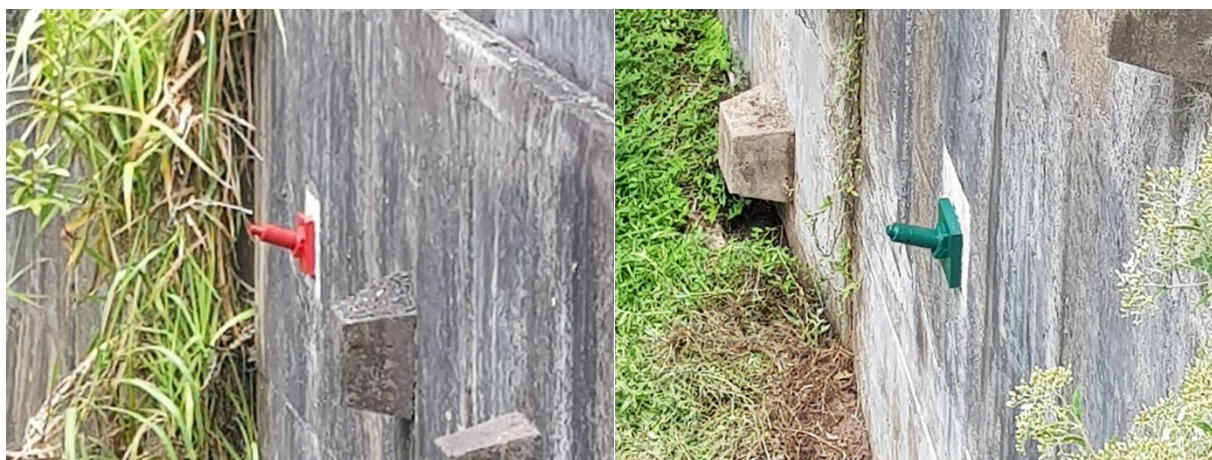
Figura 9 - Pintura anticorrosiva da cabeça dos tirantes reprovados em vermelho (esquerda) e aprovados em verde (direita) no ensaio de carga.
