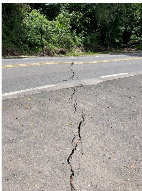
Figura 4 – Trinca com abertura de aproximadamente 2 cm em formato côncavo atingindo o acostamento e a pista entre o km 176+820 e o km 177+120 LE
