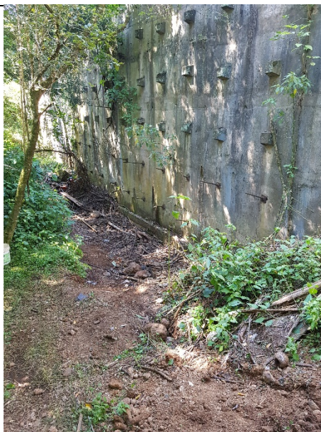
Figura 5 – Cortina a jusante da rodovia com grande parte dos tirantes rompidos e fissuras na face, entre o km 177+260 e o km 177+560.
