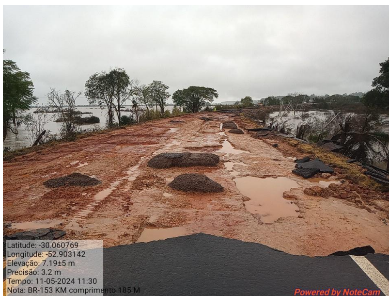
Figura 5 – Erosão de pista no km 406,330. SRE-RS – UNIDADE LOCAL SANTA MARIA
