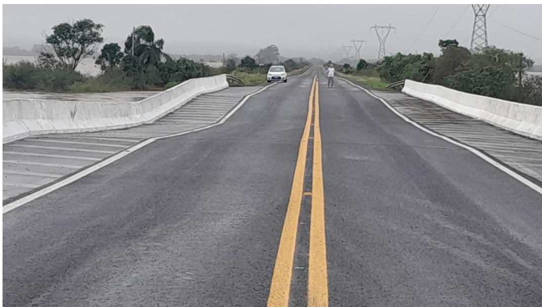
Figura 4 – Ponte da várzea do Rio Toropi – problema na mesoestrutura no km 312,460.
