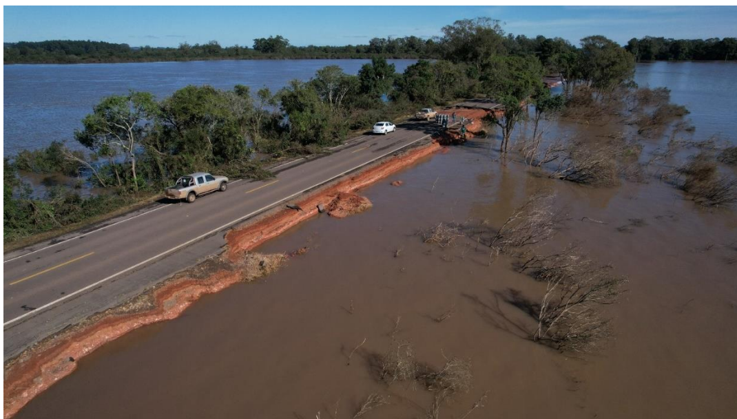
Figura 6 – Erosão de talude no km 407,500.
