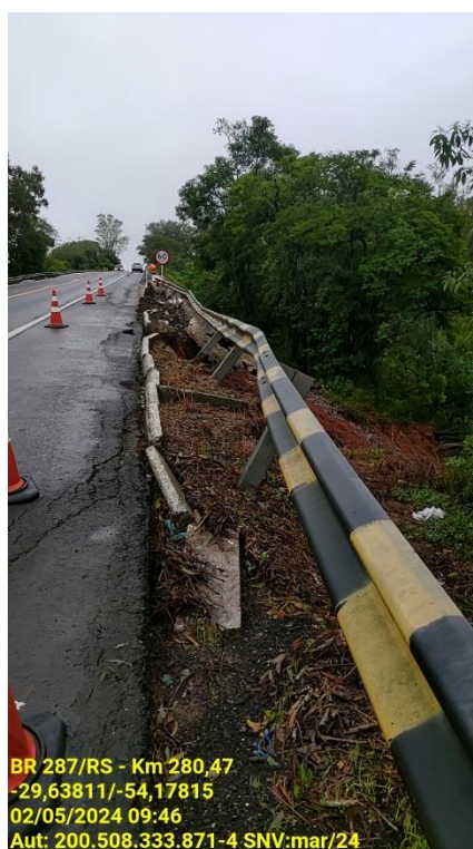
Figura 3 – Deslizamento de talude em solo com abertura de trincas e rebaixamento do acostamento do pavimento no km 280,470.
