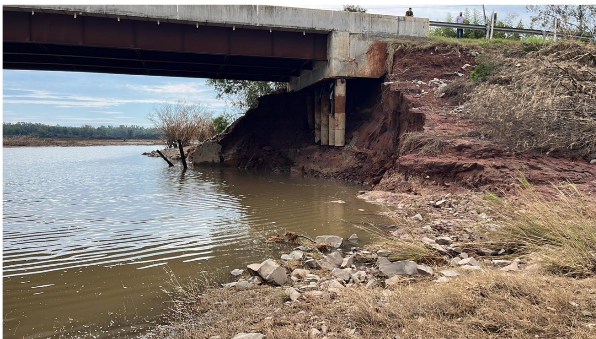
Figura 3 - Km 408,600 – Aterro erodido e fundação da Ponte do Castagnino exposta
